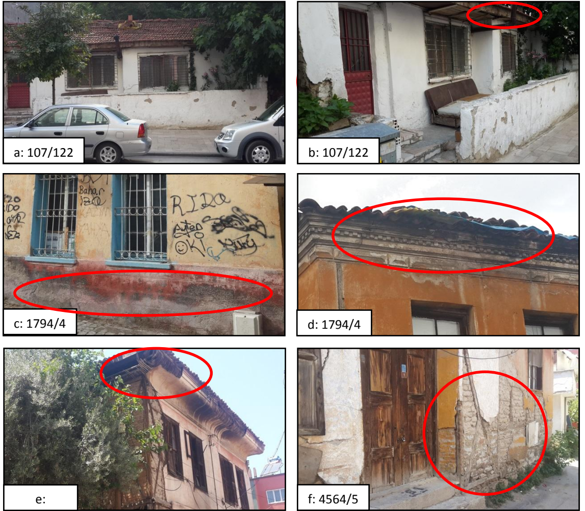
3.17a, b, c, d, e, f Nem belirtilerinin görüldüğü yapı örnekleri (Kişisel Arşiv, 2016).
