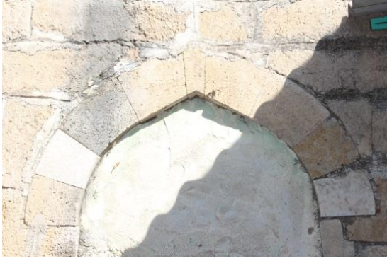
Foto. 149: Aşağı Cami Türbesi, Batı Cephe Kemerinden Detay
