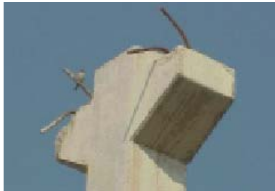
Şekil 3.5: Pimli bağlantı ve bağlantı noktasından kopan makas
