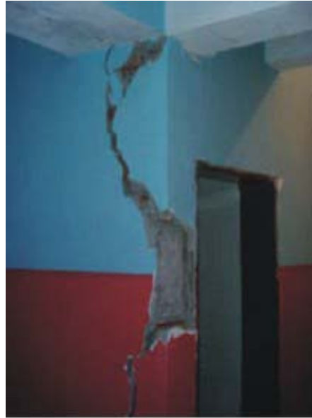
Şekil 3.4 Okul Binalarının Kiriş ve Duvarlarında Meydana Gelen Hasarlar
