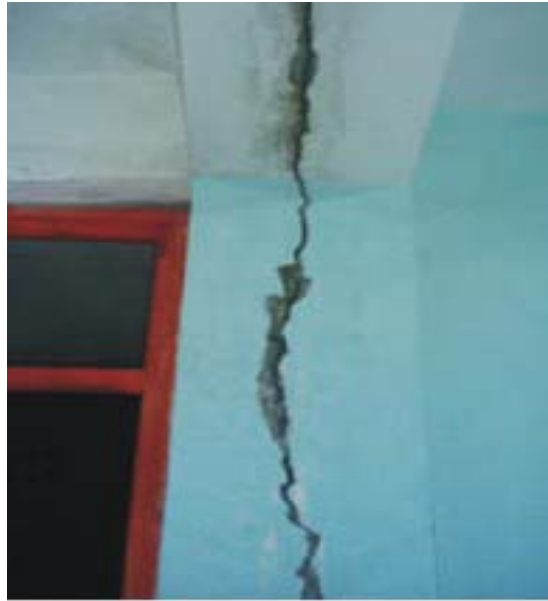
Şekil 3.5 Okul Binası ve YİBO'larda Meydana Gelen Hasarlar
