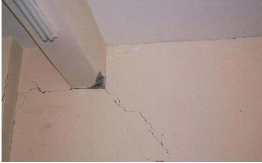
Şekil 3.2 Kirişin Yakın Mesafedeki Kolona Mesnetlenmeyip Kirişe Saplanması Sonucu Oluşan Çatlamlar
