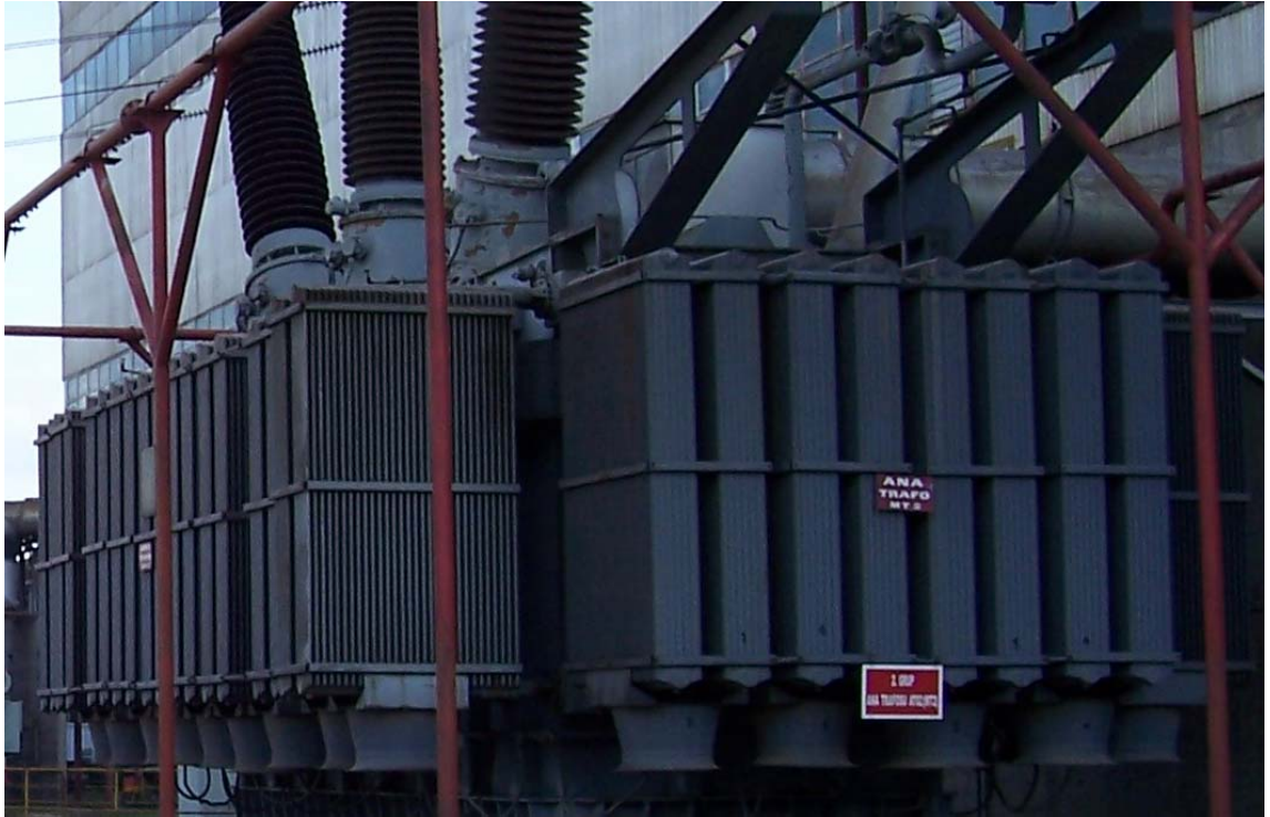
Şekil 4.6 Ana trafo (Anonim 2006)
