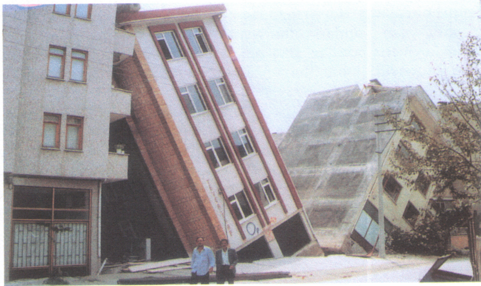
Şekil 5.13 1999 Kocaeli (İzmit) depreminde Adapazarı'nda eğilme formunda aşırı temel deformasyonuna maruz kalmış binalar (Sucuoğlu vd 2000)
