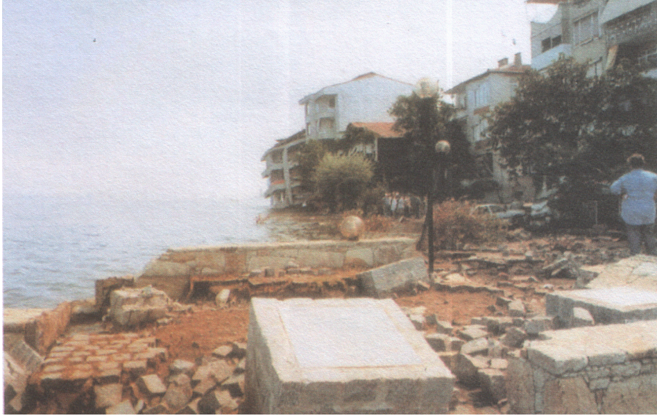
Şekil 5.8 1999 Marmara depremi sonrası Değirmendere sahilinin görünüşü. Kıyıya dolgu yapılarak kazanılmış olan alanlar 50m'ye yaklaşan yanıl yayılımlar ile denize kaybedilmiştir (Sucuoğlu vd 2000)
