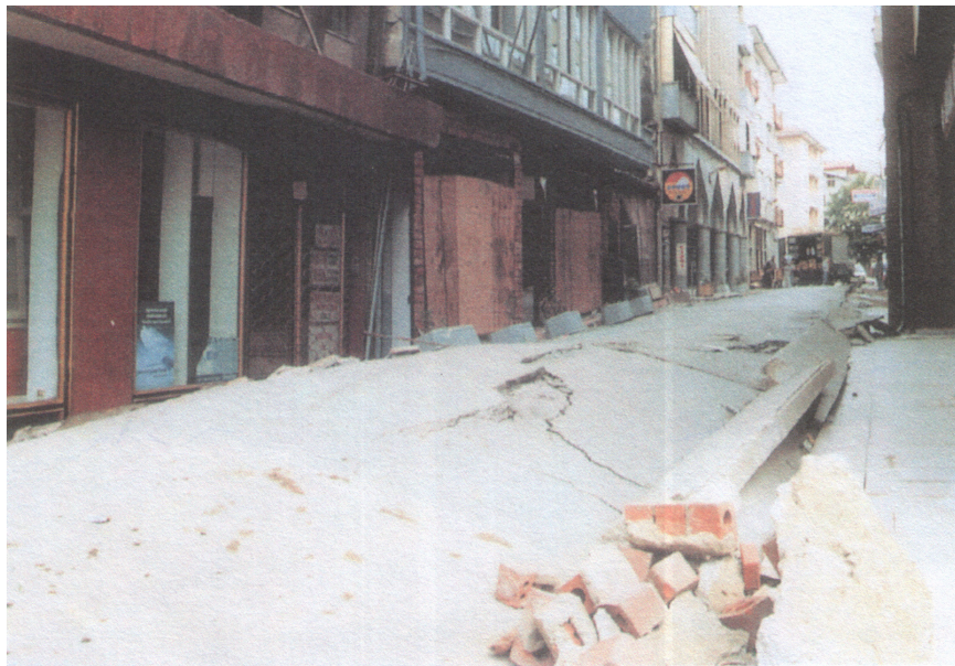
Şekil 5.14 1999 Marmara depremi sonrası zemin deformasyonlarına bağlı olarak yol ve kaldırımlarda meydana gelen kabarmalar (Sucuoğlu vd 2000)
