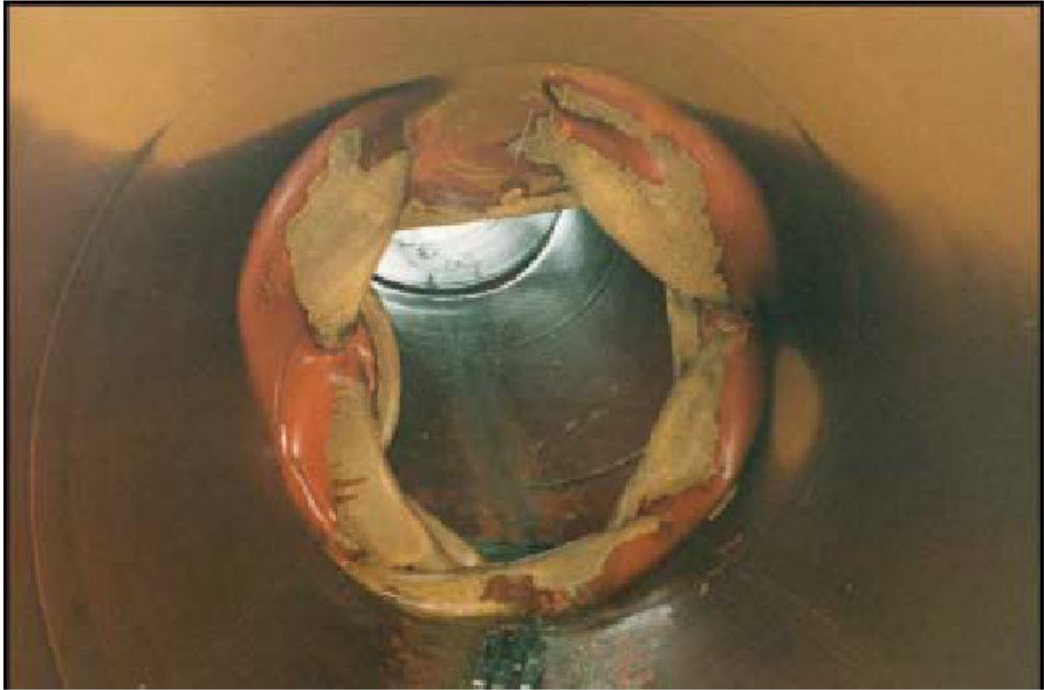
Şekil 5.2 Boruda fay kırığı hareketi sonucu oluşan buruşma (Eidinger vd 2002)
