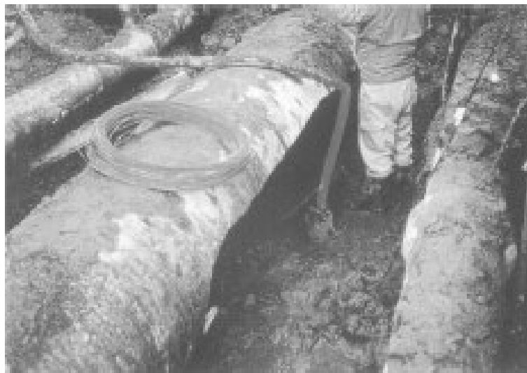
(b) 0.8 m çaplı font boru hasarı
