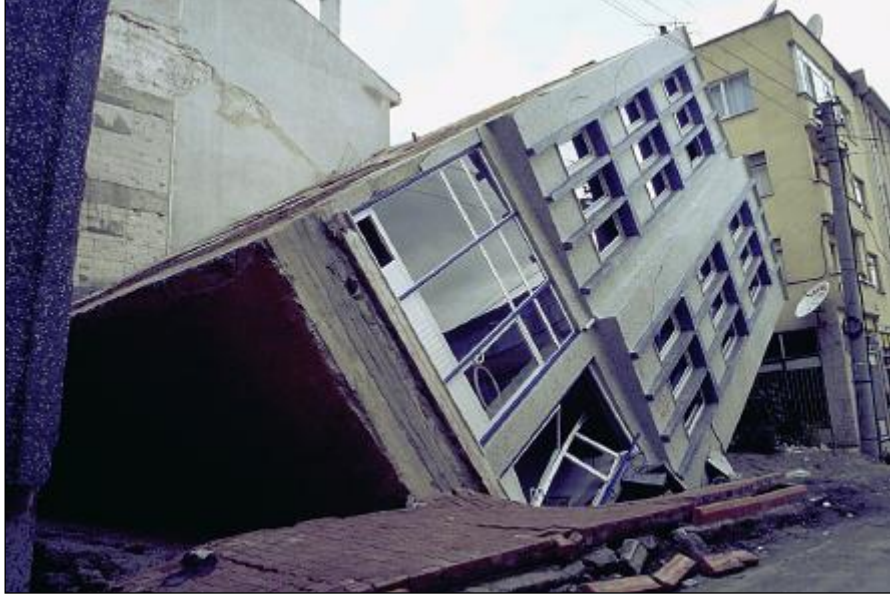
Şekil 4.3: Zeminin taşıma gücünü yitirmesi (17 Ağustos 1999 Kocaeli-İzmit depremi).
