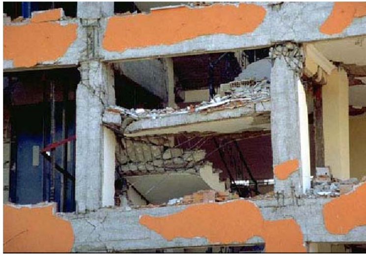
Şekil 2.9 : 1999 Kocaeli depreminde hasar görmüş bir yapıda merdiven bölgesinde kısa kolon oluşumu
