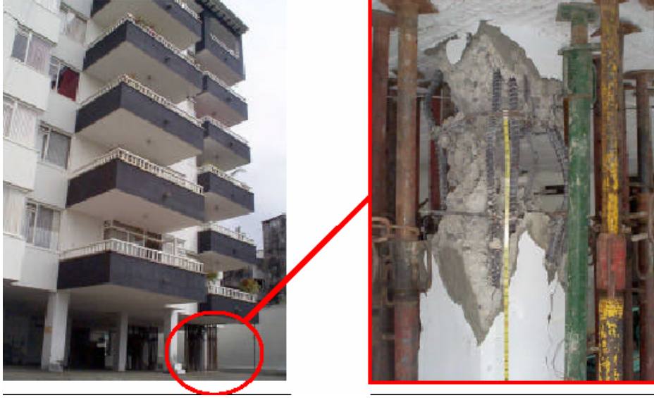
Şekil 2.11 : 1999 Armenia Kolombiya Depreminde hasar görmüş ağır kapalı çıkmalara sahip bir yapı
