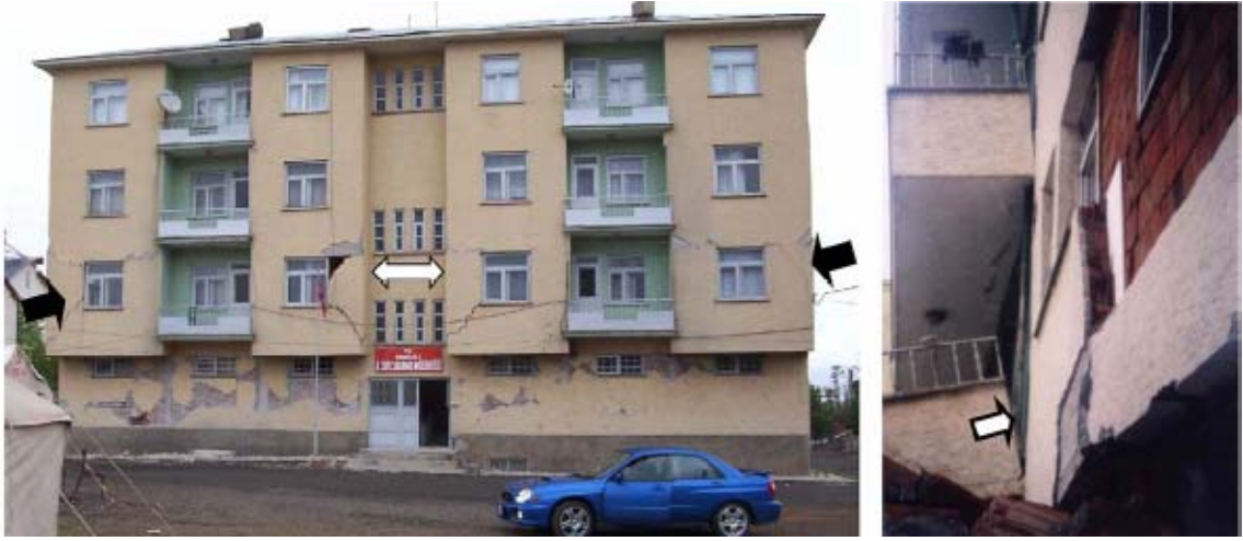
Şekil 2.10 : 2003 Bingöl depreminde hasar görmüş ağır çökmelere sahip bir yapı
