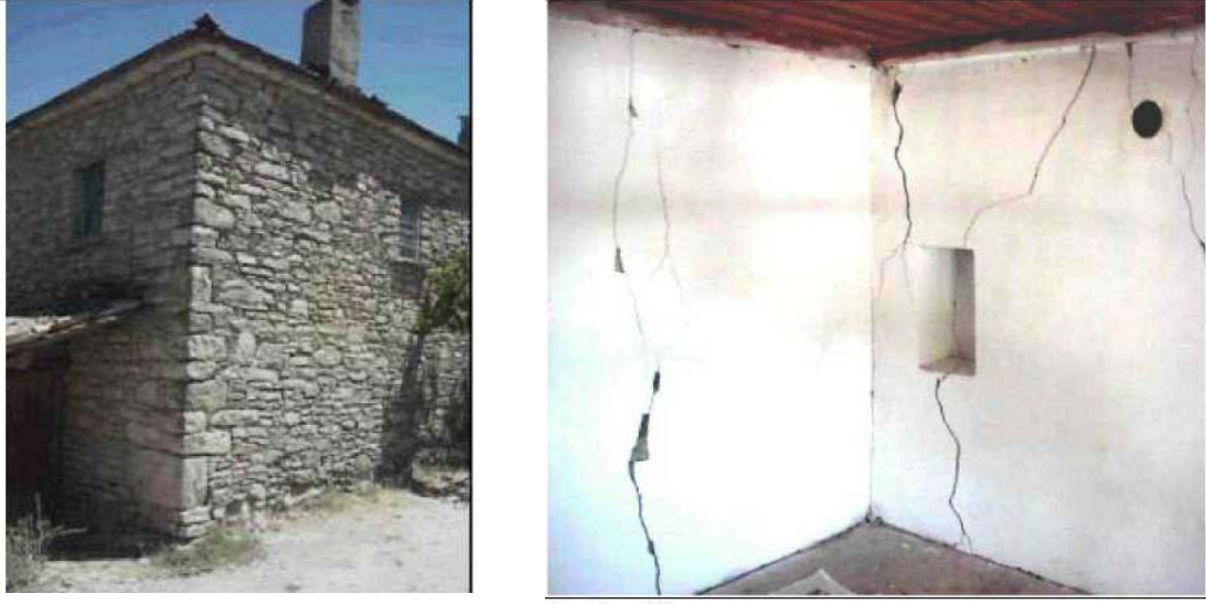
Şekil 3.26: Binanın hasarsız olarak görünen dış görünüşü ve iç kısımdaki hasarlar
