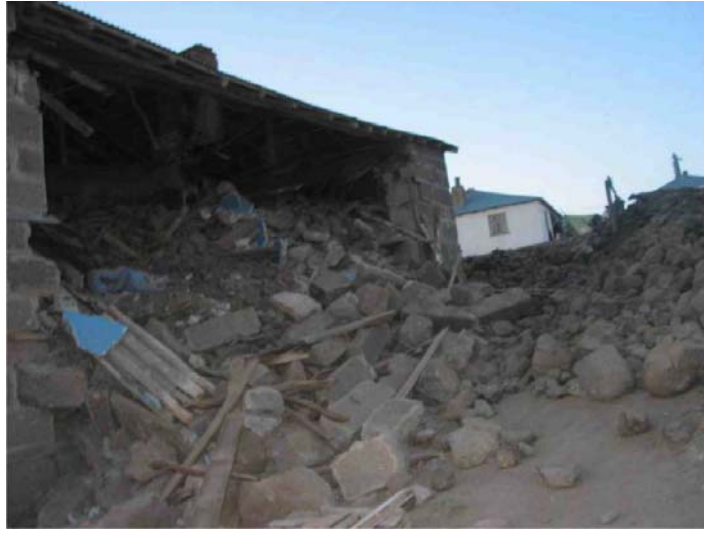
Şekil 3.10: Yiğma yapıda duvar yıkılması
