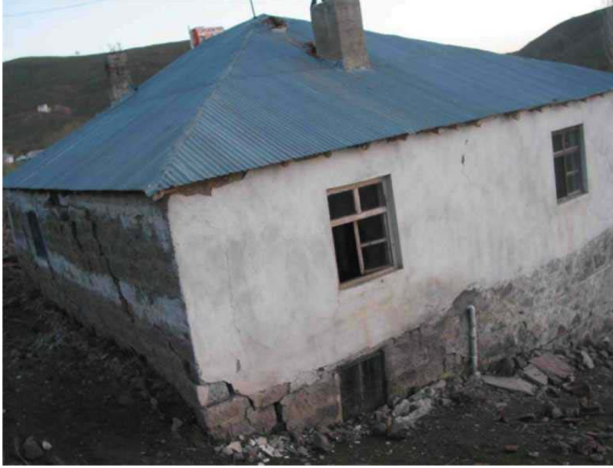
Şekil 3.14: Ağır Hasarlı Bir Ev
