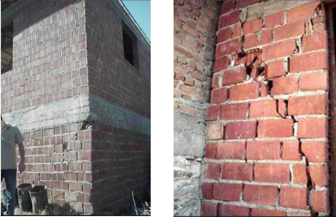
Şekil 3.33: Yığma yapıda oluşan hasarlar.
