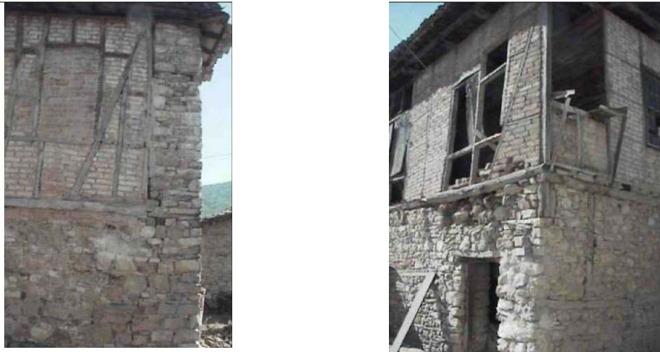
Şekil 3.27: Kagir yapıda Köşede kenetlenme eksikliği ve uygunsuz boşluk hasarları
