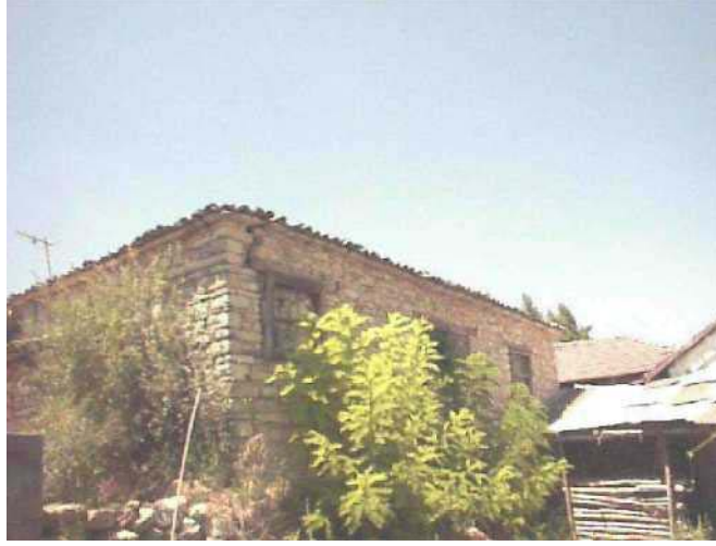
Şekil 3.22: Köşeye çok yakın pencere boşluğunun neden olduğu hasar
