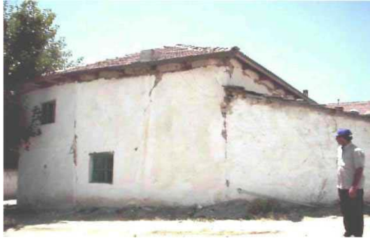
Şekil 3.21: Birleşim bölgelerinde hasarlar
