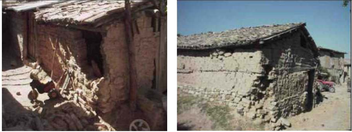
Şekil 3.35: Hasar gören hayvan barınakları
