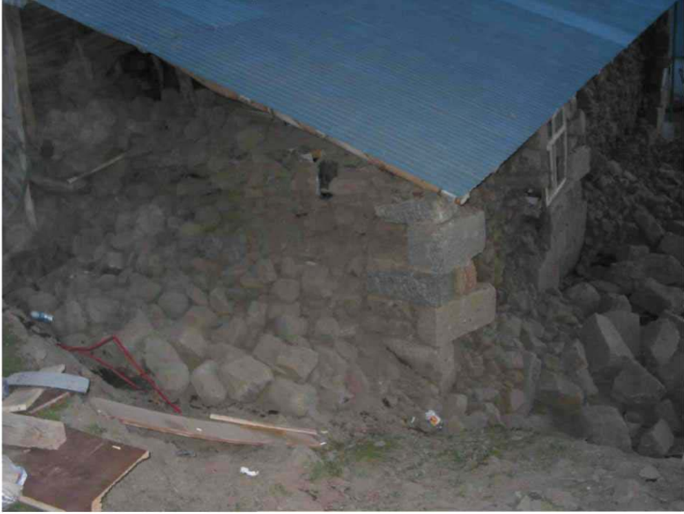
Şekil 3.7: Yığma yapıda yetersiz köşe birleşimi ve hasar
