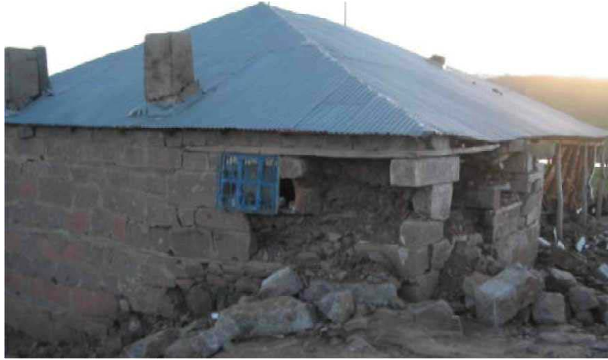
Şekil 3.1: Çimenli Köyünde tipik Köy evi ve deprem Hasarı
