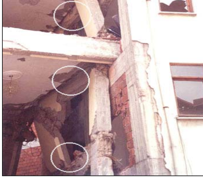
Şekil 3.9 Döşeme-kiriş birleşim bölgelerinde oluşan hasarlar
