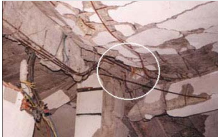
Şekil 3.10 İleri derecede hasar gören yapıda döşeme çatlakları
