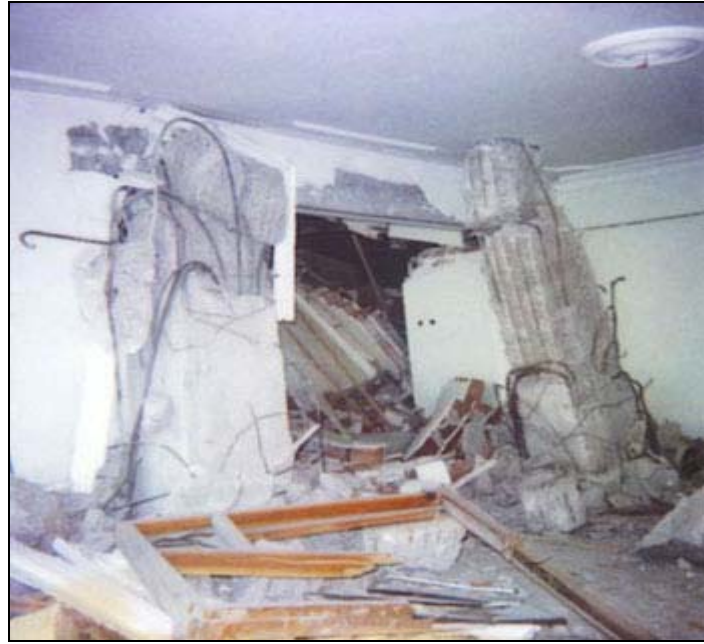
Şekil 3.4 Zimbalama etkisi ile döşemede oluşan hasar
