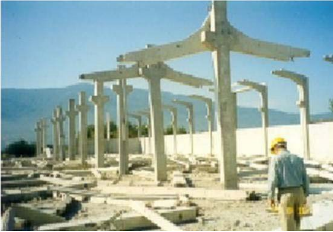
Şekil 2.2: 1999 Marmara Depreminde Göçmüş Prefabrik Yapı
