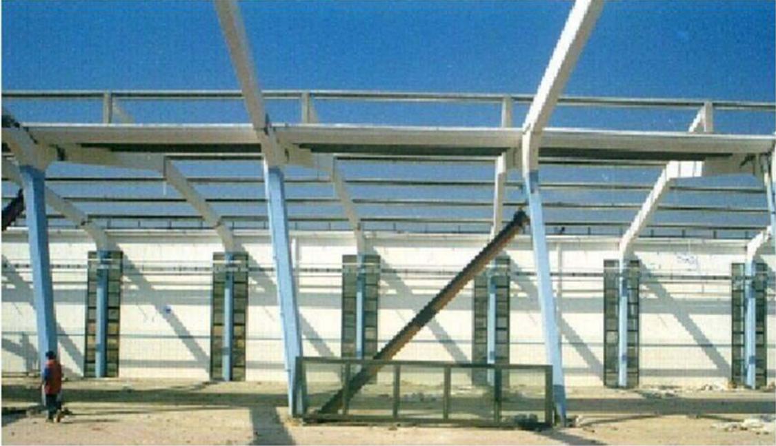
Şekil 2.5: Prefabrik Yapıda Çerçevelerin Dolgu Duvar Nedeniyle Farklı Ötelenmesi.
