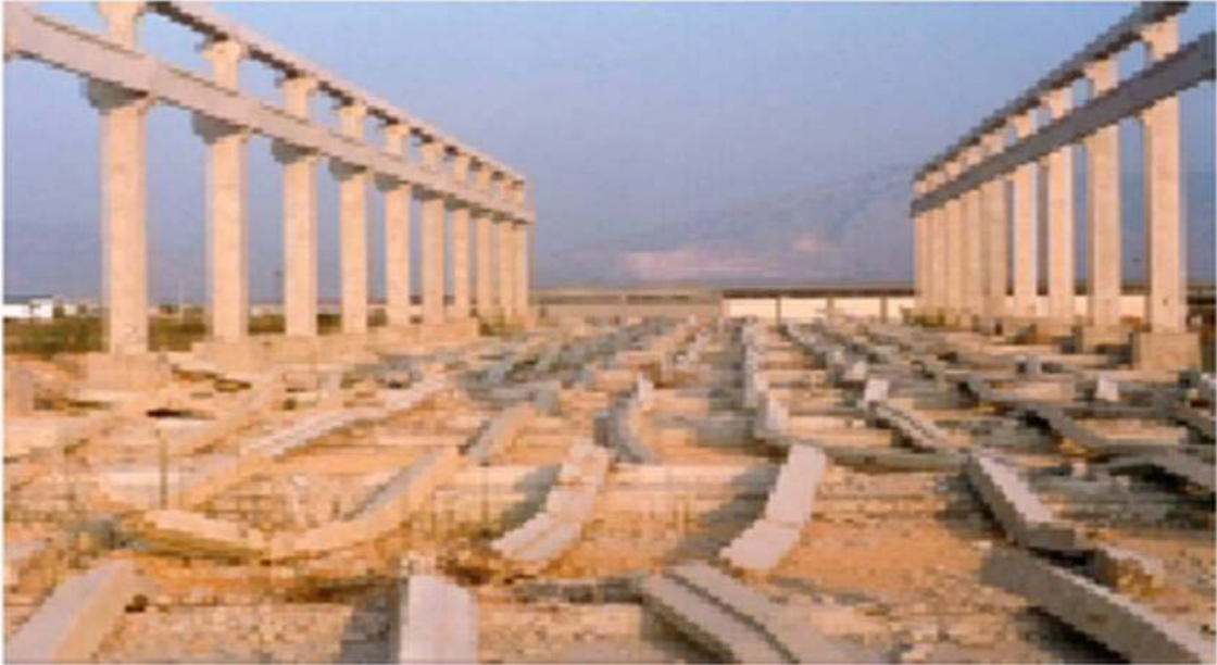
Şekil 2.1: Ceyhan Depreminde Makas ve Aşık Kirişleri Dökülmüş Prefabrik Yapı
