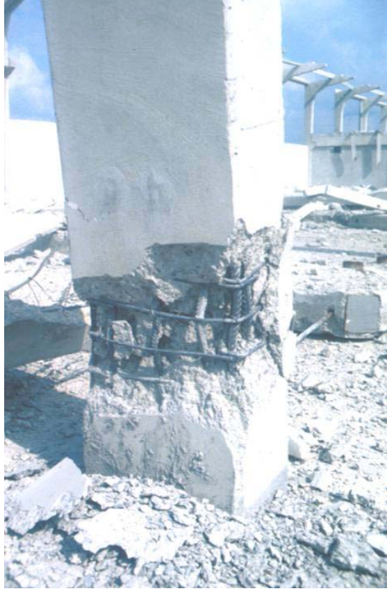
Şekil 2.8: Göçmüş Prefabrik Yapıda Kolon Tabanındaki Mafsallaşma
