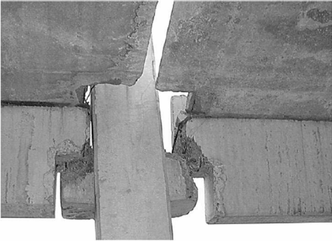
Şekil 2.6: Kolon Kiriş Birleşim Bölgesinde Hasar
