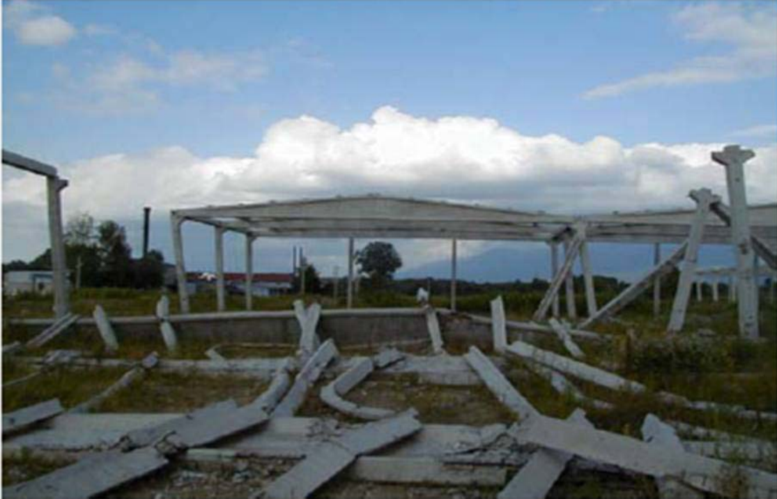
Şekil 2.3: 1999 Marmara Depreminde Göçmüş Prefabrik Yapı
