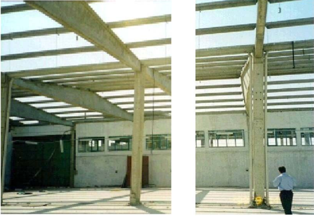
Şekil 2.4: 1999 Marmara Depreminde Prefabrik Binada Kolon Alt Bölgesinde Mafsallaşma ve Makas Kirişinin Yanal Deplasmanı
