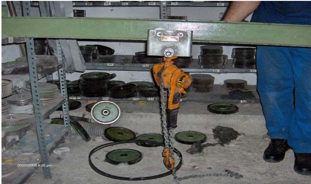
Şekil 5.16 Brizör çıkarımı için bakım sırasında makine iç tavanına monte edilen caraskal mekanizmalı aparat
