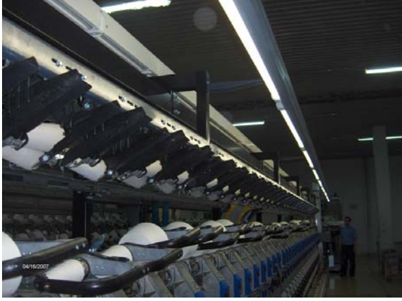
Şekil 5.1 Bobin makinesi aydınlatma tertibatı
