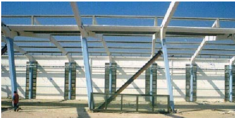
Şekil 3.11 Kolonlarda yatay ötelenme hasarı (Ersoy vd 2000)
