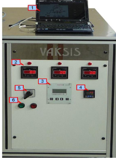
Şekil 2.7: Isısal buharlaştırma sisteminin elektronik kabin ünitesi
