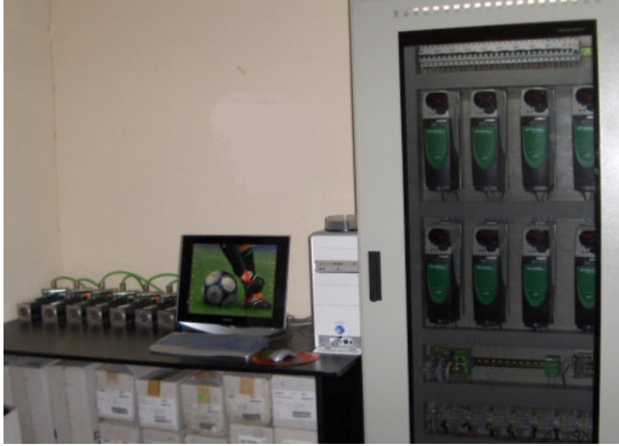
Şekil 2.11 Sekiz eksen robot kolu için yapılan elektrik panosu ve servo sistem
