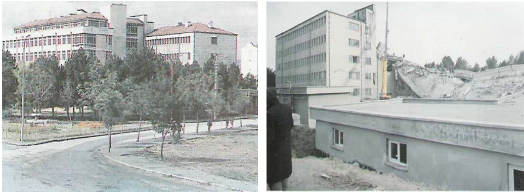
Şekil 2.6 SSK binasının depremden önce ve sonra görünümü
