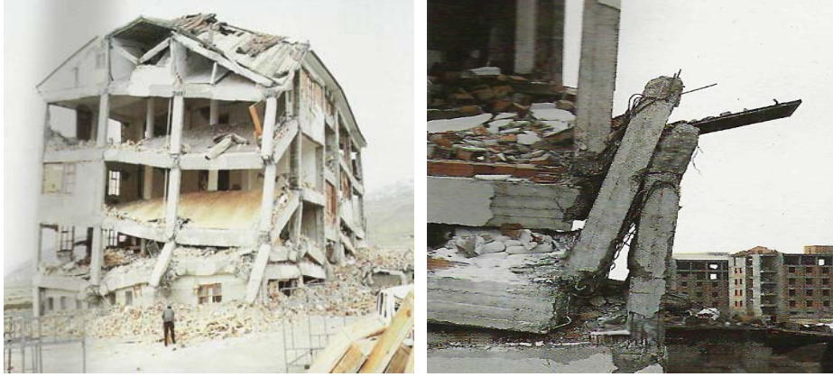
Şekil 2.8 Yapısal burulma sonucu çökmüş bir bina
