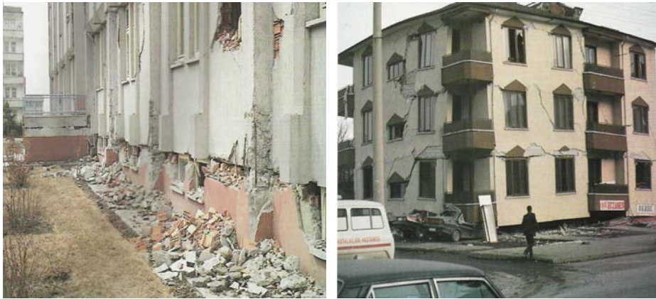
Şekil 2.9 Kısa kolon ve yumuşak kat hasarları
