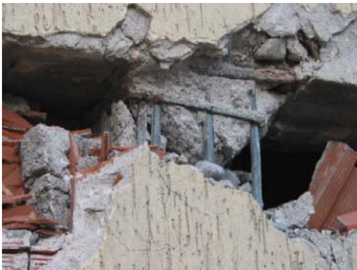
Şekil 2.5 Zayıf betonun dağılması
