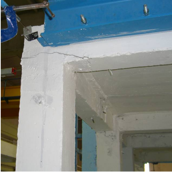
Şekil 4.27 Yapının ikinci katında hasar durumu (sol aks)
