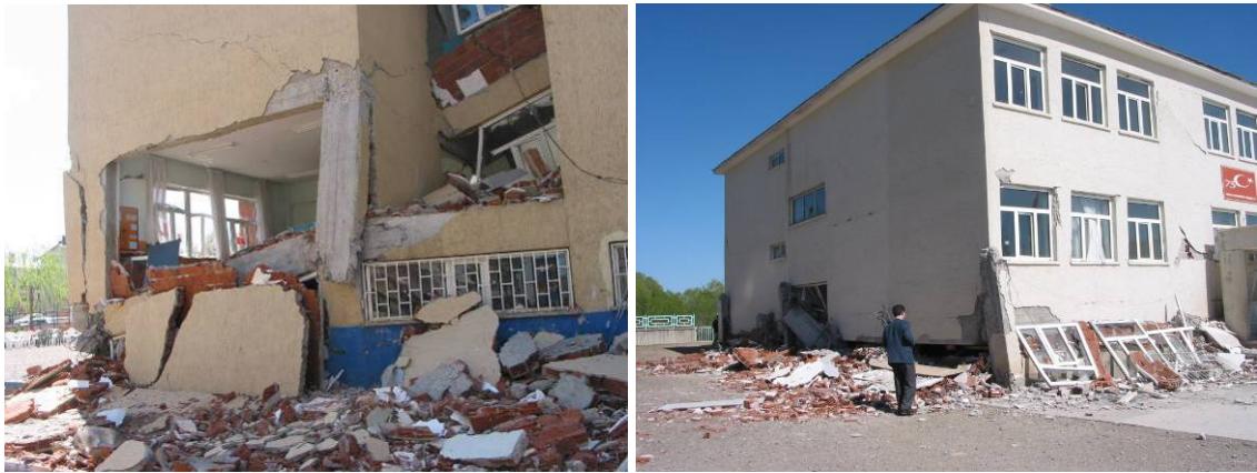
Şekil 3.7 Bingöl depreminde soğuk derz bölgesinde oluşan hasar (Kaplan 2003)
