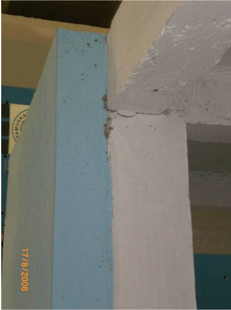
Şekil 4.51 Perde-kolon arasında oluşan kılcal çatlak
