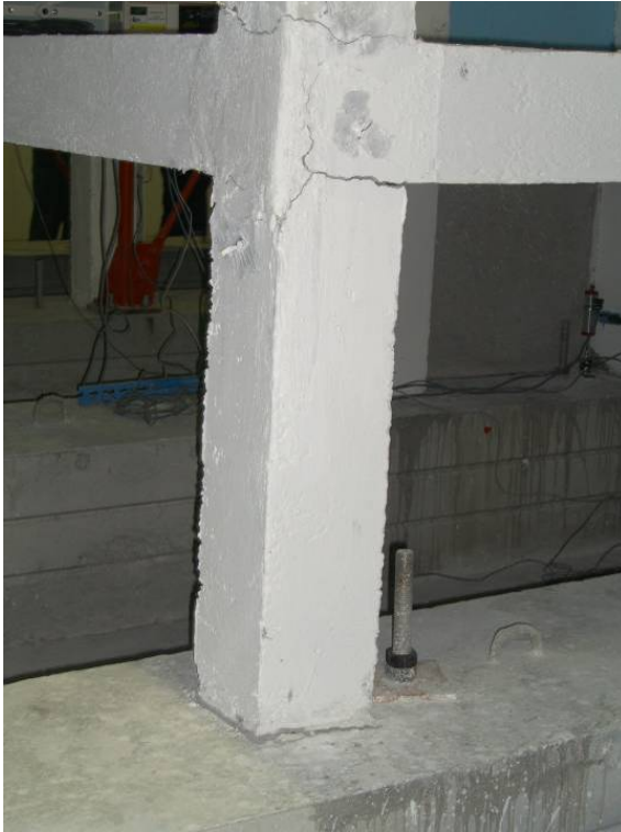
Şekil 4.28 1. Kat kolonunda oluşan ötelenme ve hasar
