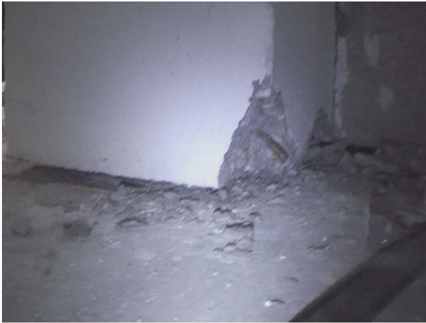
Şekil 4.25 Kolon-perde donatılarının eğilme davranışı ile kopması
