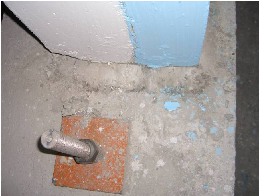
Şekil 4.50 Deney sonunda perde tabanında oluşan kalıcı ötelenme
