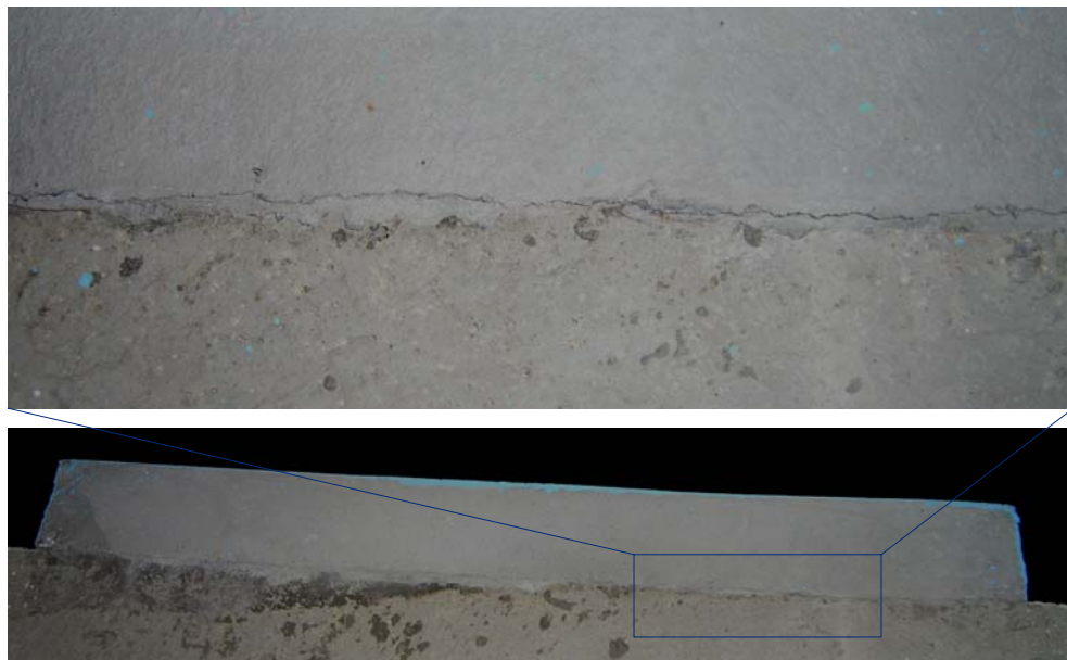
Şekil 4.52 Perde-döşeme arasında oluşan kılcal çatlak
