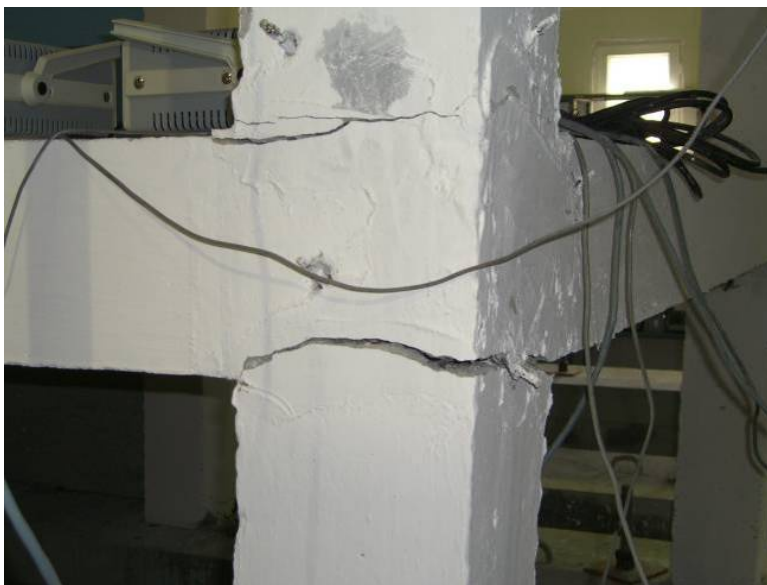
Şekil 4.26 Köşe kolon kiriş birleşiminde kolon hasarları
