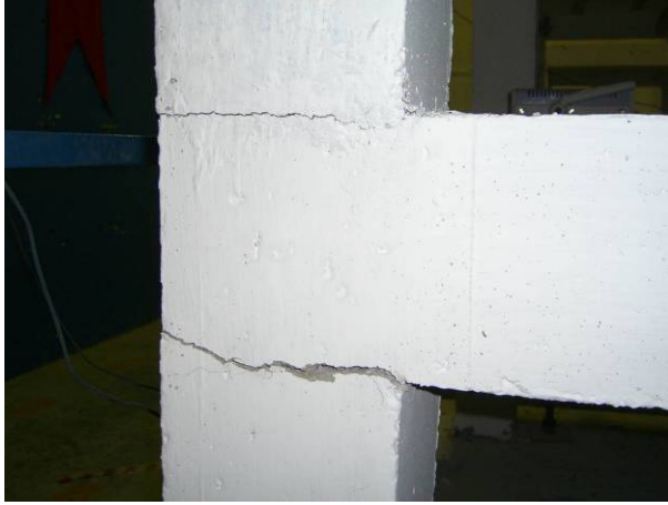
Şekil 4.43 Oluşan çatlakların genişlemesi
