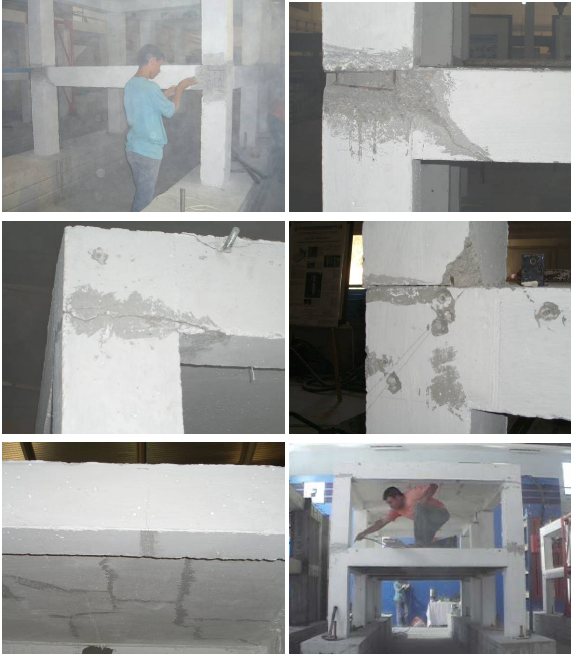
Şekil 3.22 Kabuk betonunun döküldüğü bölgeler ve çatlakların etrafının temizlenmesi
