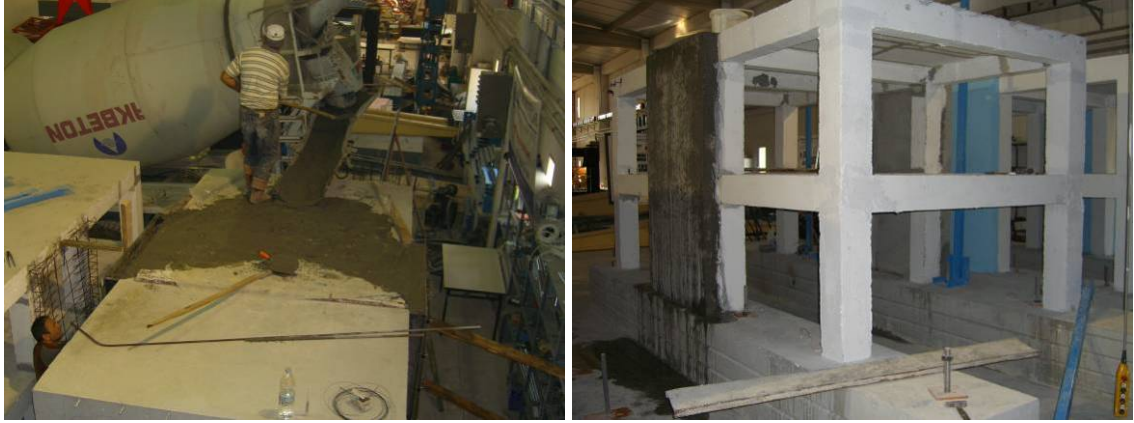
Şekil 3.28 Dış perde betonunun dökülmesi
