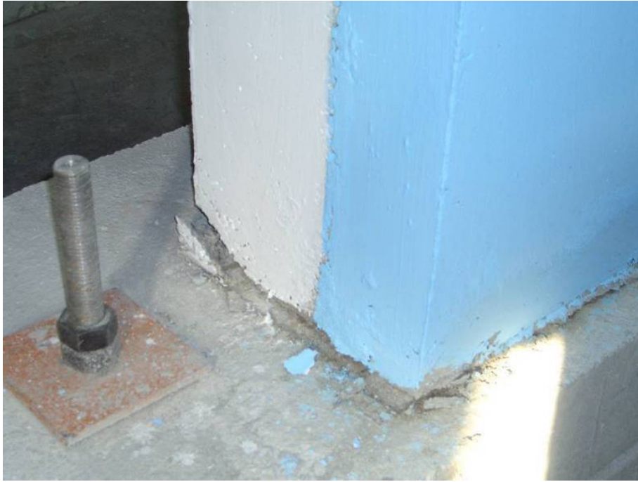
Şekil 4.49 Perde tabanında kayma hasarı başlangıcı (sağ aks)
