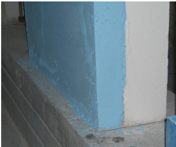
Şekil 4.22 Numunede ilk çatlak oluşumu
