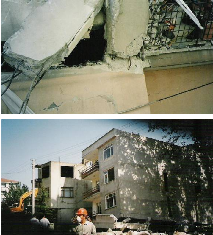
Şekil 3.8 Kocaeli depreminde soğuk derzlerde oluşan hasarlar (Kaplan 1999)
