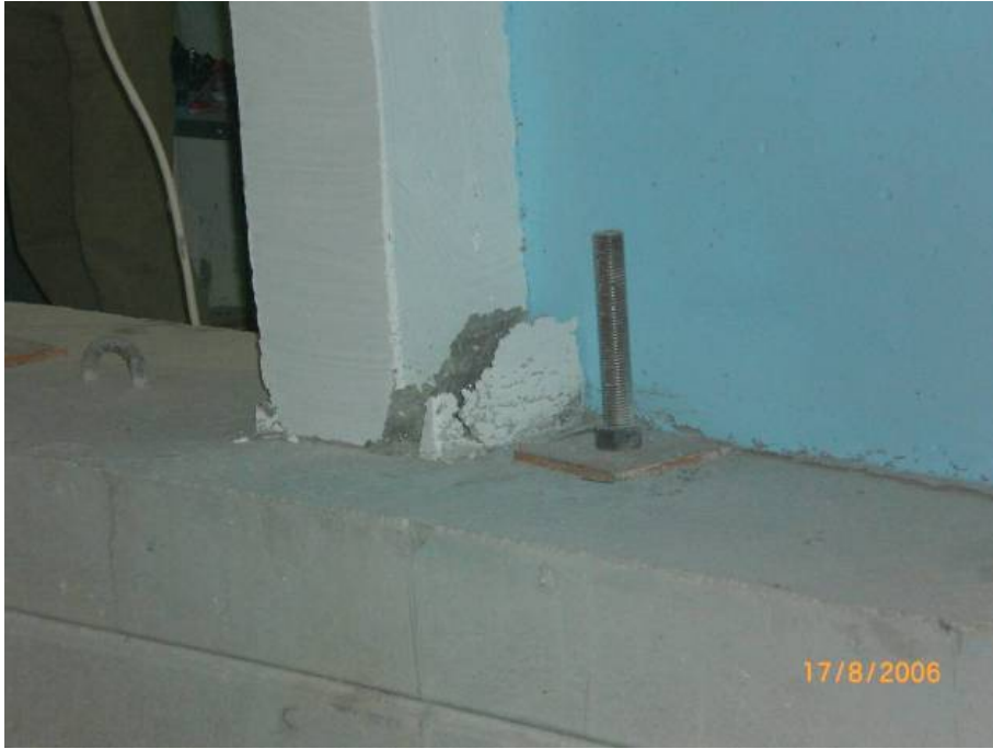
Şekil 4.47 Perdeye bağlı kolonda basınç etkisinde kabuk dökülmesi
