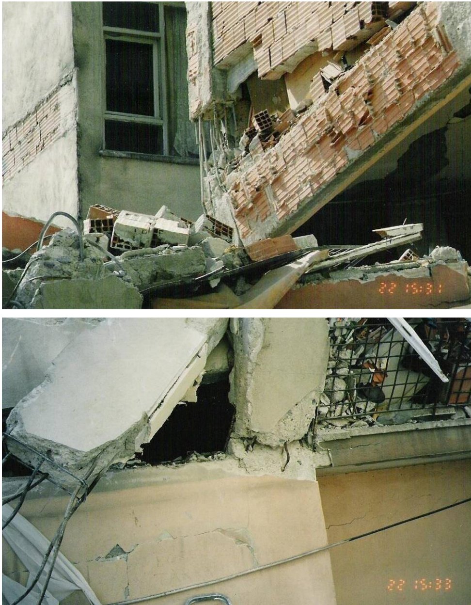
Şekil 3.10 Yetersiz bindirme veya kenetlenme boyu nedeniyle oluşan hasarlar (Kaplan 1999)
