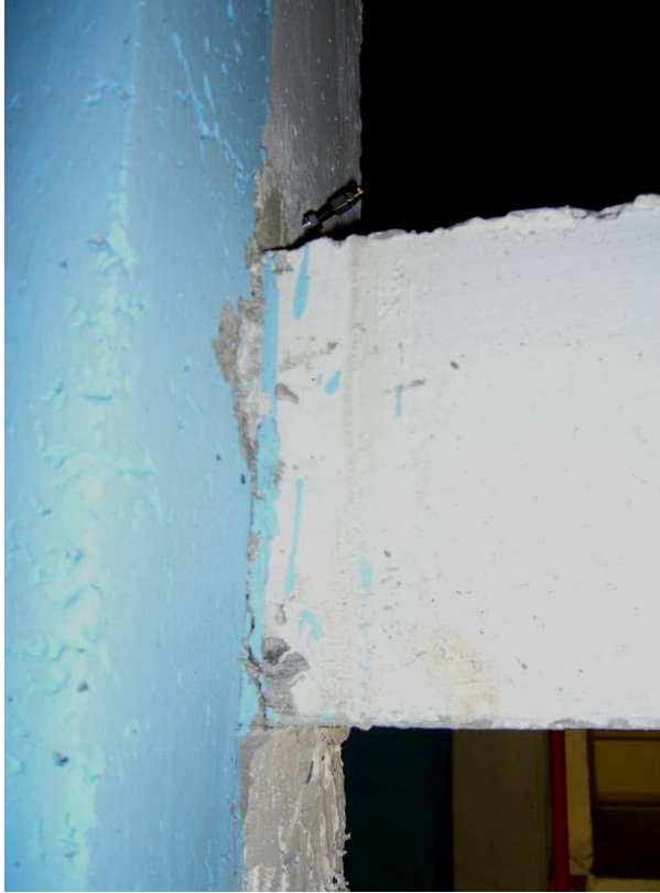
Şekil 4.29 Perdeye bağlanan kirişte eğilme hasarı
