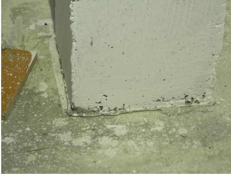
Şekil 4.10 Kolon-temel bağlantısında çatlak oluşumu
