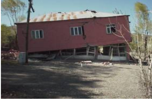
Şekil 3.1 Yumuşak katlı yapı hasarı (Kaplan 2004).
