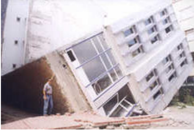
Şekil 3.9 Zeminin sıvılaşması sonucu oluşan hasar (Kubin 1999).
