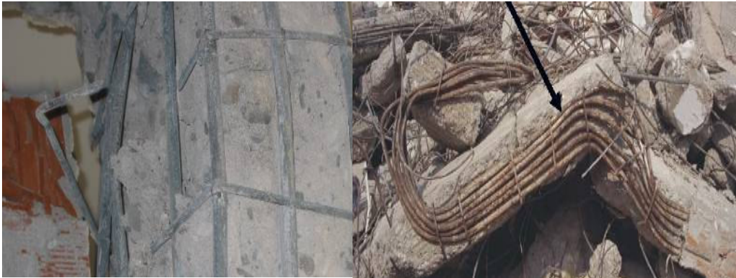
Şekil 3.4 Detaylandırma kusurları (a)Sol: Kancası 90^{\circ} kıvrılan etriye, (b)Sağ: Aderansı sağlanmayan donatılar (Kaplan 2004).
