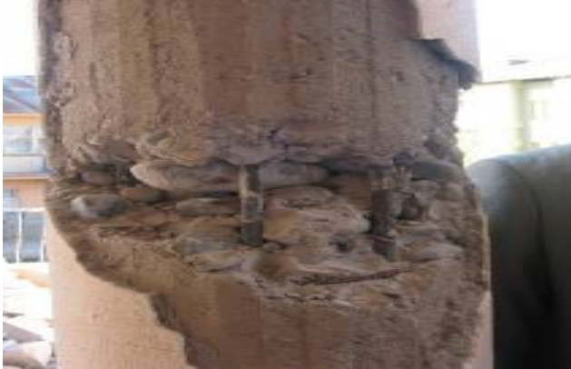
Şekil 3.8 Uygun olmayan beton kalitesi sonucu hasarlar (Kaplan 2004).
