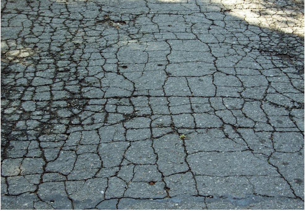
Şekil 2.1 : Esnek kaplama tabakasında oluşan yüksek şiddette timsah sırtı çatlak (Sealco Sealcoating)
