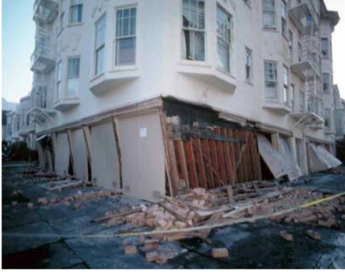
Şekil 2.5 San Francisco'daki 1989 Loma Prieta depreminde zemin kattaki garajlardan dolayı oluşan yumuşak kat
