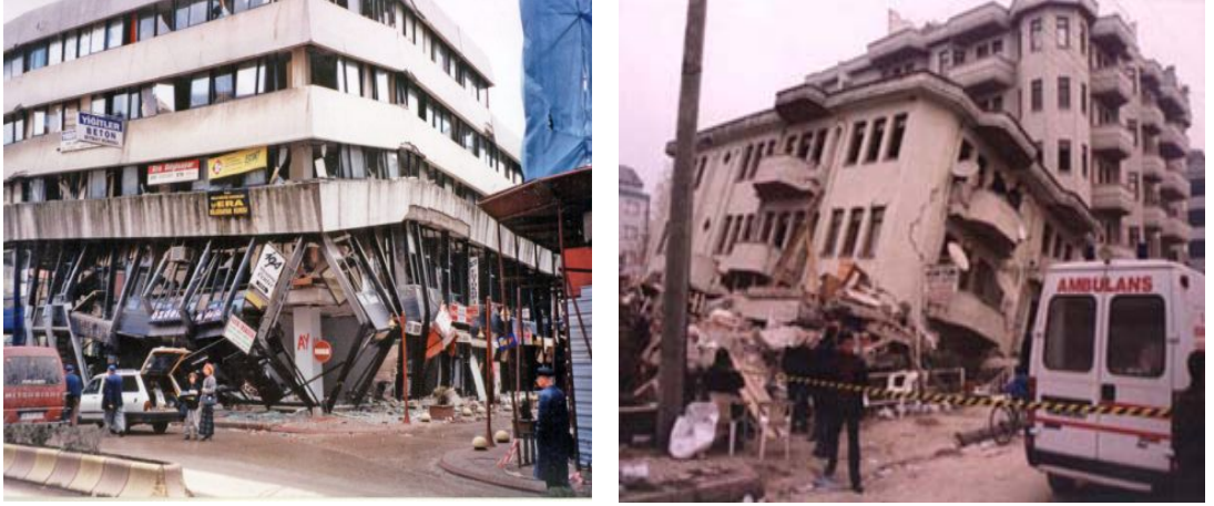
Şekil 2.3 1999 Düzce depreminde oluşan yumuşak kat
