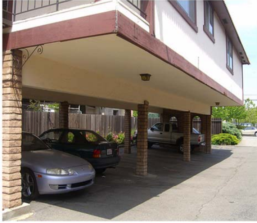
a) Dolgu duvarın bulunmaması
