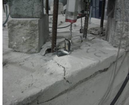
Betonun yarılması f20c20
