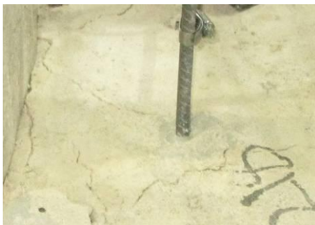
Betonun yarılması f12c18
