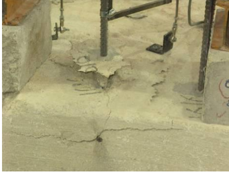
Betonun yarılmamas ve sıyrılmamas f16c16
