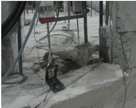
Betonun yarılması f12c18
