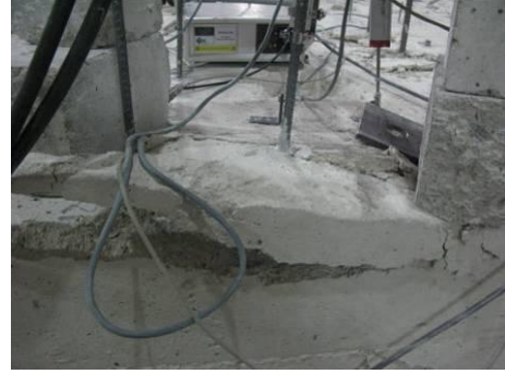
Betonun yarılması f12c12
