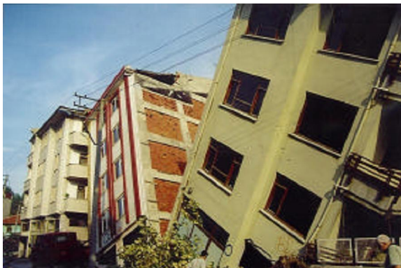
a) Adapazarı'nda sıvılaşma sonucu yan yatmış binalar (Yeniğün-Tığcılar mahallesi, Hasırcılar sokakta yer alan Yağcılar ve Teverler Apartmanları) (Durgunoglu vd 2000)
