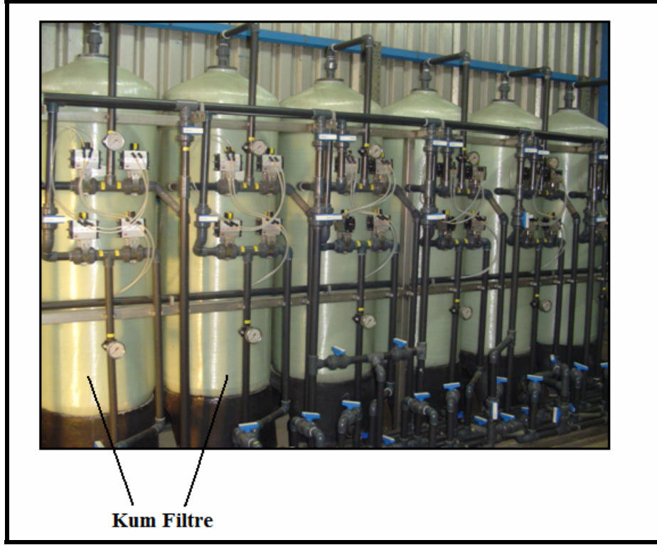
Şekil 7.4: Entegre ileri arıtma sistemi-kum filtre üniteleri
