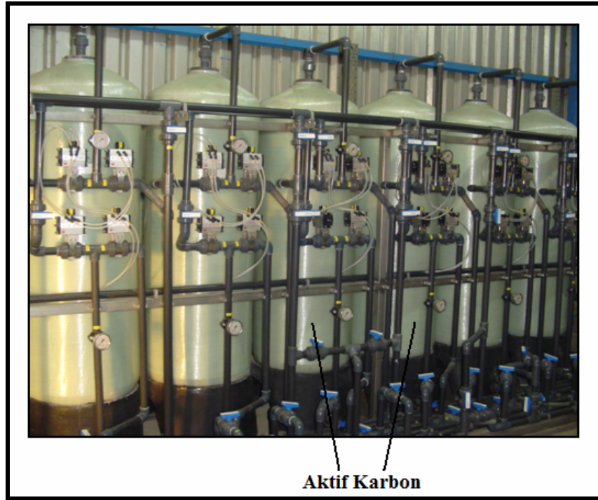
Şekil 7.7: Entegre ileri arıtma sistemi-aktif karbon üniteleri
