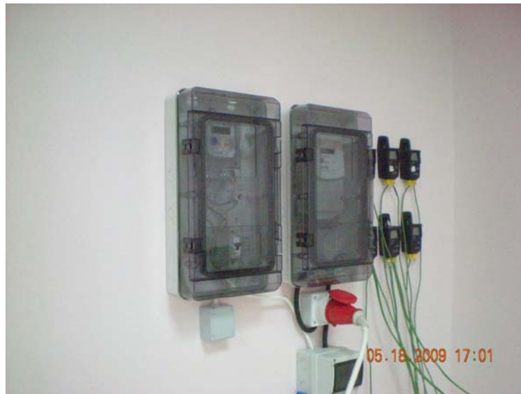
Şekil 5.8. Mono ve üç fazlı elektrik sayaçları.
