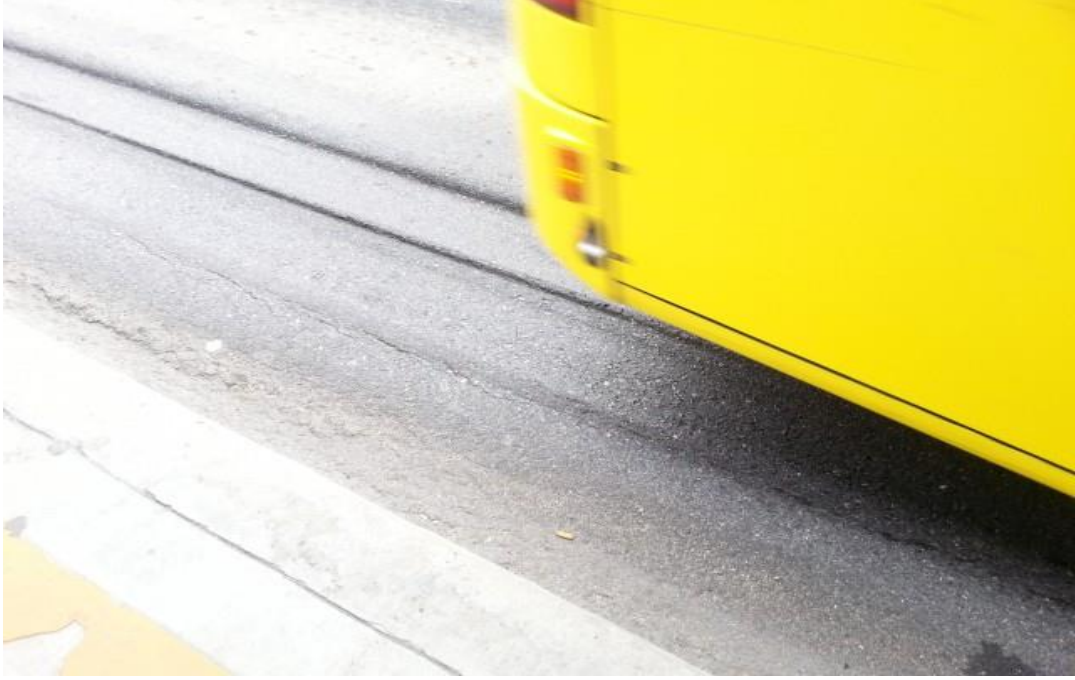
Şekil 4.9 Asfalt Tekerlek İzinde Oturma Bozulması
