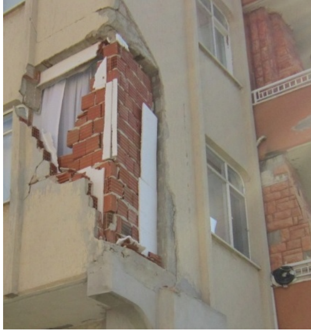
Resim 3.15: 19 Mayıs 2011 Simav depremi sonrası hatalı yalıtım uygulaması nedeniyle yıkılmış dolgu duvar
