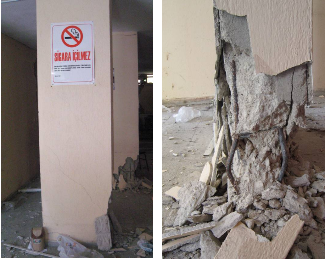
Resim 3.4: Düşey ekseninden kalıcı olarak kayan binada kolon uç bölgelerinde oluşan eğilme mafsalları ve burkulan boyuna donatılar
