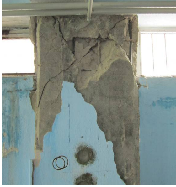
Resim 3.8: 19 Mayıs 2011 Simav depremi sonrası Cumhuriye Lisesi'nde gözlenen kısa kolon hasarı
