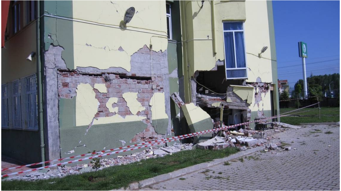
Resim 3.7: Simav Depremi sonrası göçmüş kapalı çıkma bölgesi
