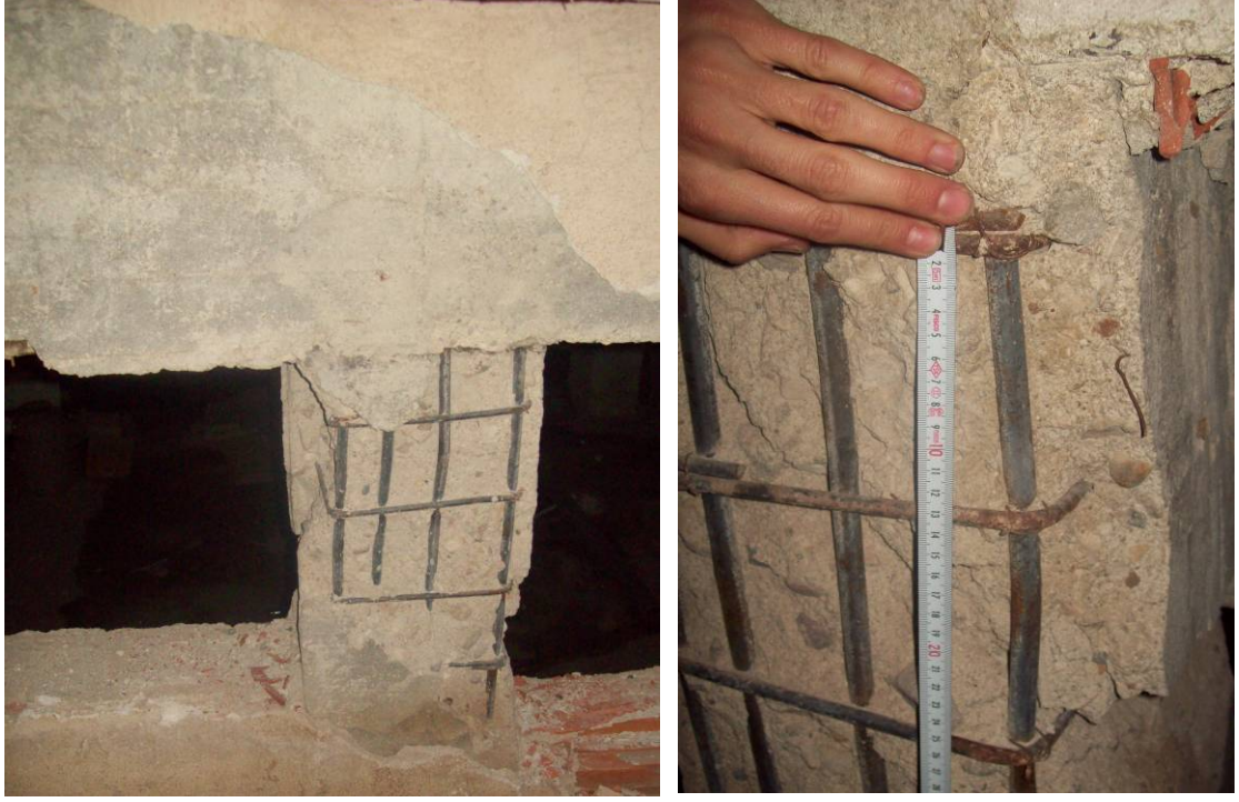
Resim 3.9: 19 Mayıs 2011 Simav depremi sonrası gözlenen kısa kolon hasarı
