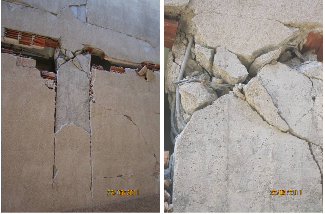
Resim 3.10: 19 Mayıs 2011 Simav depremi sonrası dolgu duvar davranışı nedeniyle oluşan kısa kolon hasarı.
