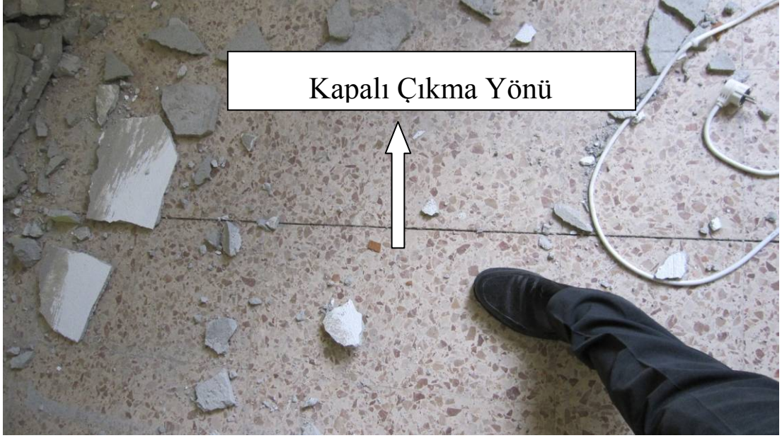
Resim 3.6: Kapalı çıkma hasarı sonrası döşemede oluşan çatlak
