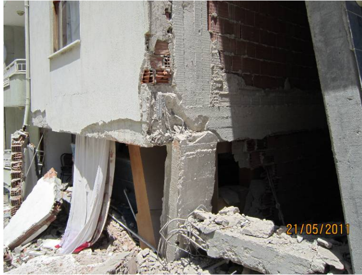
Resim: 3.2 Aynı binada güçlü kiriş-zayıf kolon davranışı
