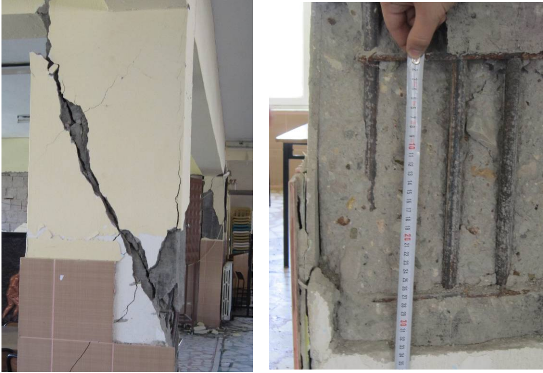
Resim 3.13: 19 Mayıs 2011 Simav depremi sonrası ağır kesme hasarı almış kolon elemanı
