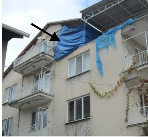
Resim 3.16: 19 Mayıs 2011 Simav Depremi sonrası yıkılan ve bir vatandaşımızın ölümüne sebebiyet veren kalkan duvar.
