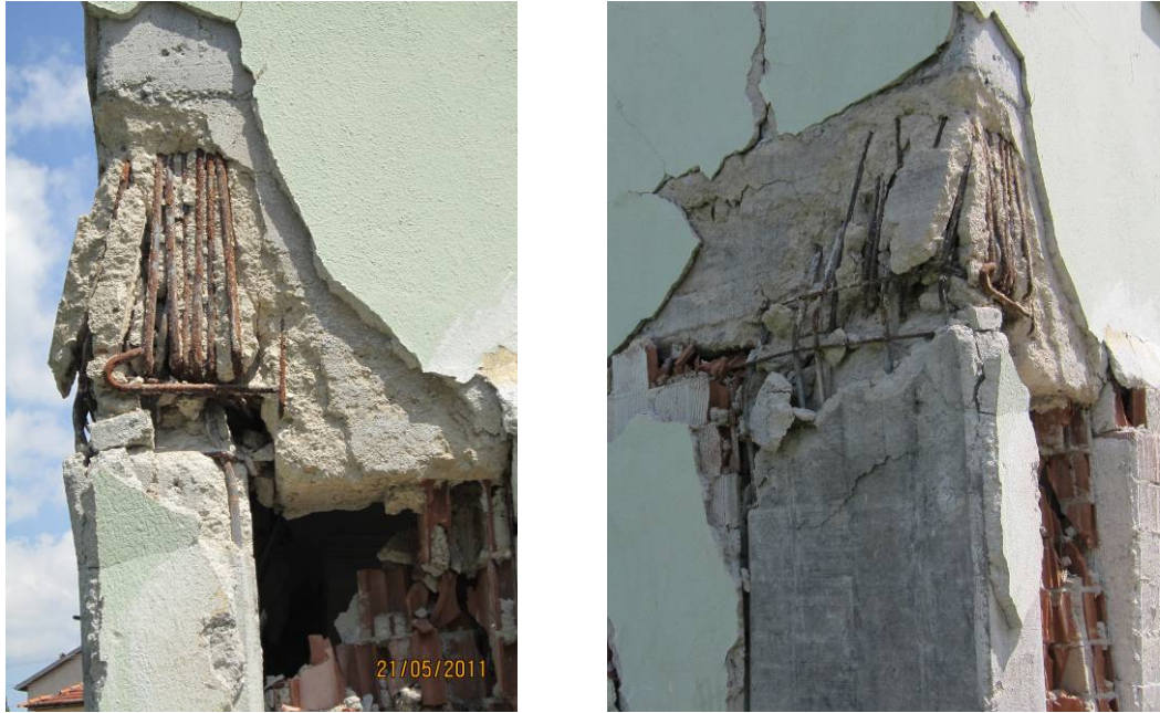
Resim 3.12: 19 Mayıs 2011 Simav depremi sonrası birleşim bölgesi ağır hasar almış betonarme yapı
