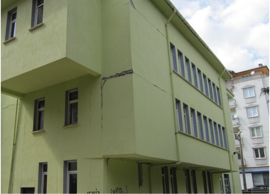
Resim 3.5: Simav Depremi sonrası hasar almış kirişsiz kapalı çıkmalı bina
