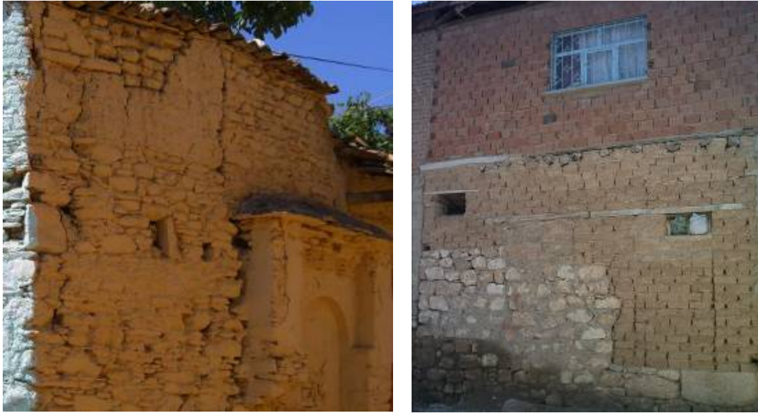
Şekil 4.13 Uygun malzeme ve bağlayıcı harç kullanılmaması sonucu oluşan hasar
