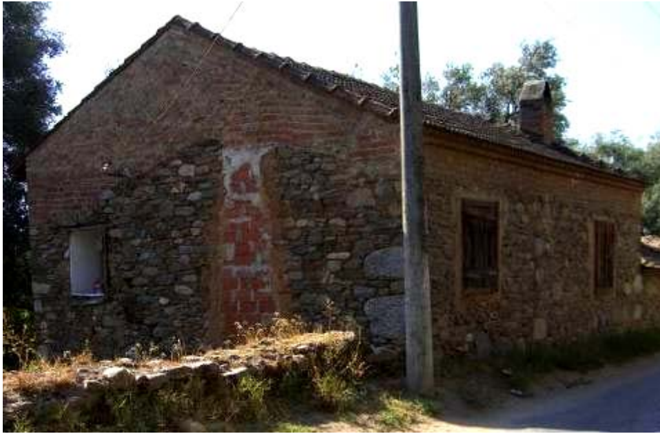
Şekil 4.12 Yığma yapıda çok farklı malzemelerin kullanılması durumu
