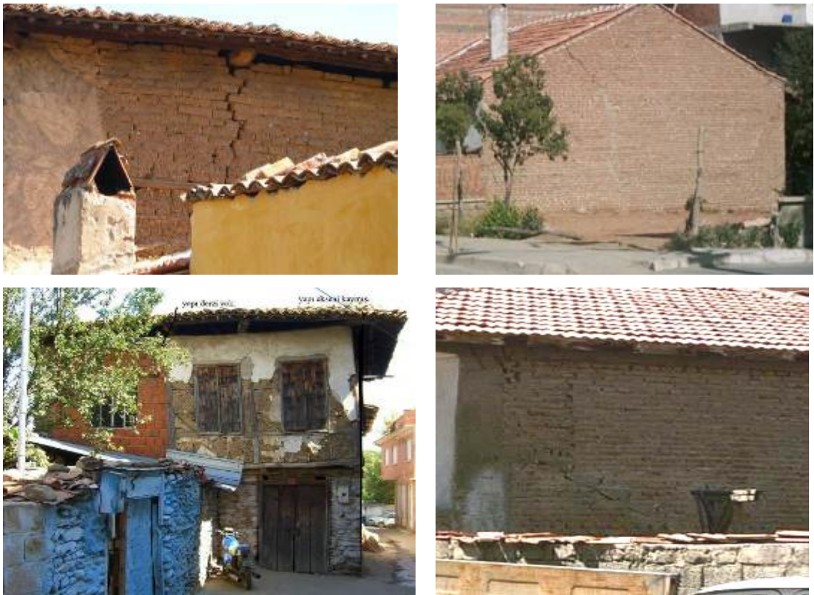
Şekil 4.24 Yığma yapı hasarlarına örnekler
