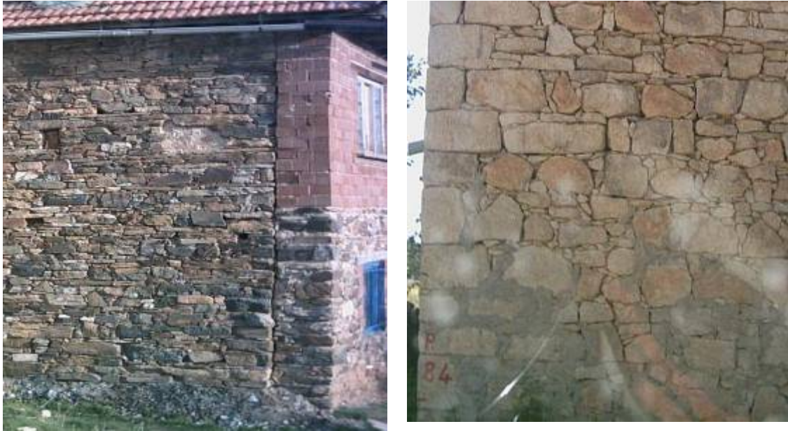
Şekil 4.21 Bina köşesinde derz oluşması ve uygunsuz harç kullanımı
