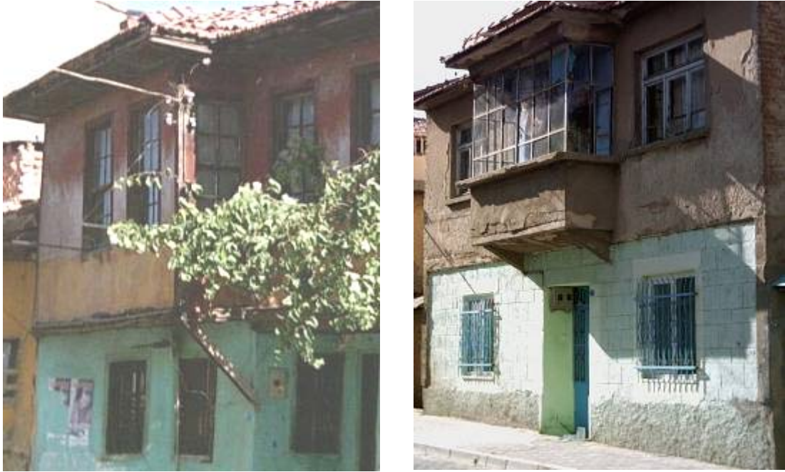
Şekil 4.42 Dik kesen duvarlarda yapı boşlukları mesafesinin sağlanamaması.
