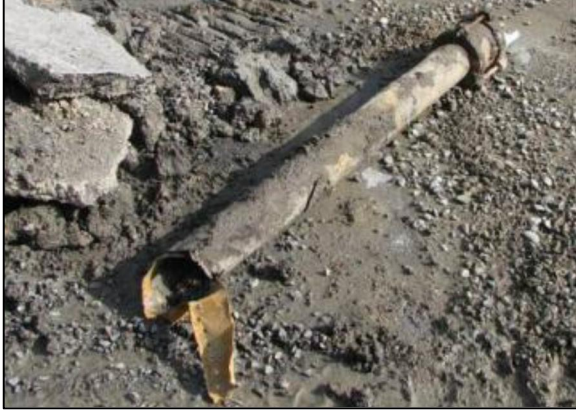
a) Sarmal Perçinlenmiş Çelik Boru Hasarı
