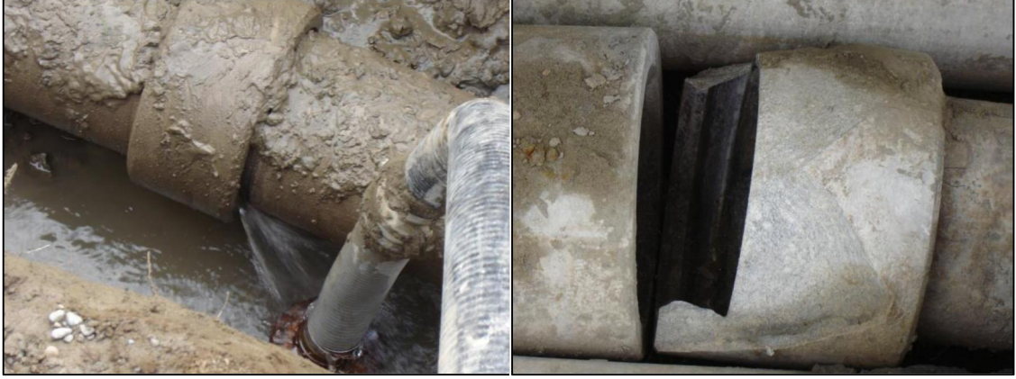
a) AC tipi boru bağlantı bölgesinde çekme etkileri, Sewell Caddesi, Kaiapoi b) AC tipi boru bağlantı bölgesinde basınç etkileri, Sewell Caddesi, Kaiapoi
