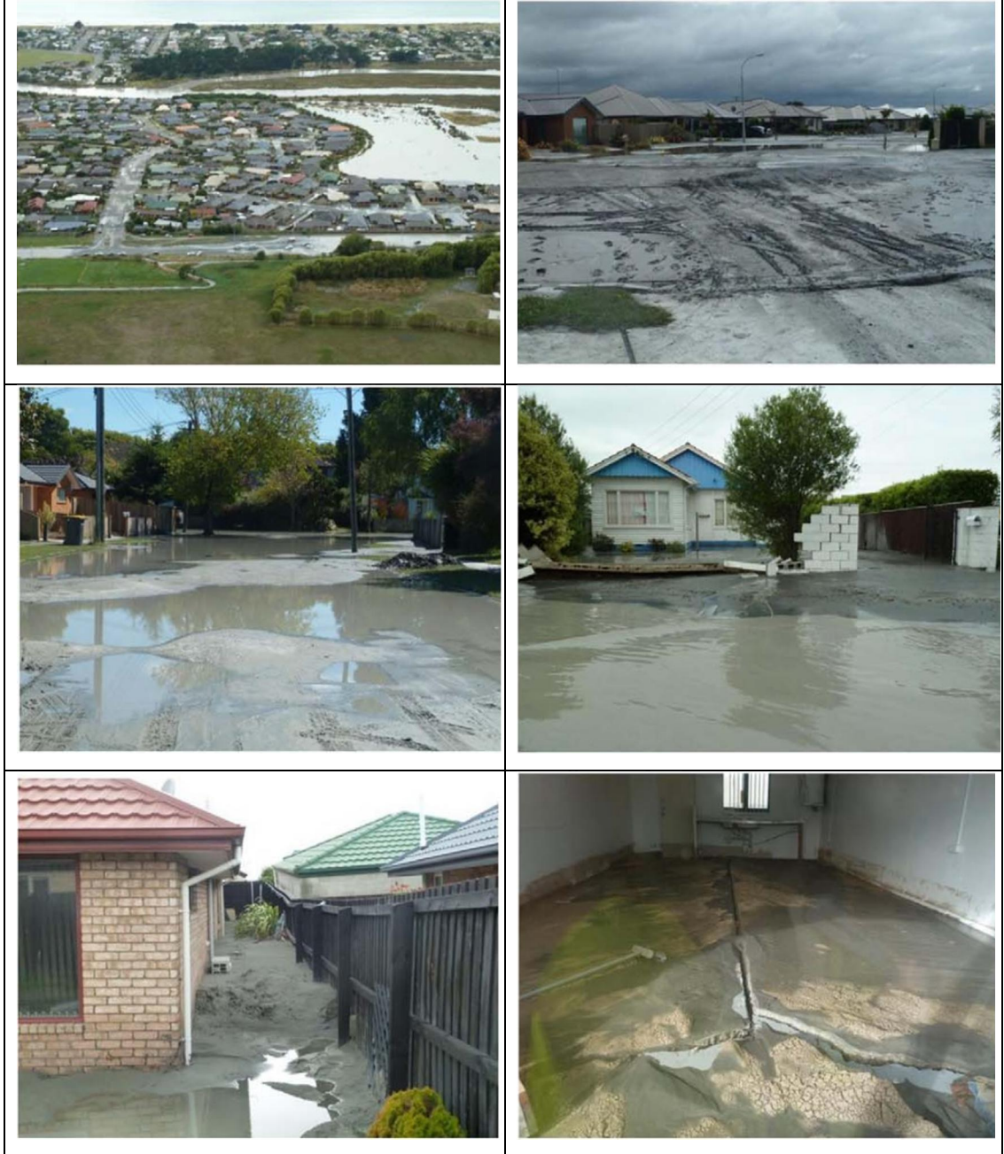
Şekil 4.3: Christchurch şehrinde Canterbury deprem dizisi sonrasında sıvılaşma ile ilgili arazi hasarları ve yerleşim yapılarındaki hasarlar (Van Ballegooy ve diğ. 2014 a )
