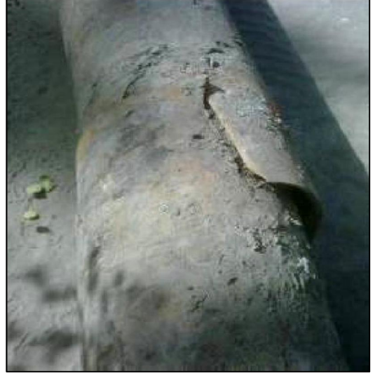
b) Beton Kaplamalı Çelik Boruda Ayrılma (fotoğraf; P. Free)
