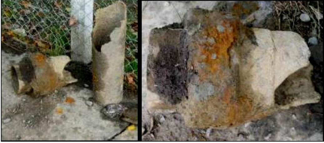
c) Dökme Demir Boruda Kırılma
