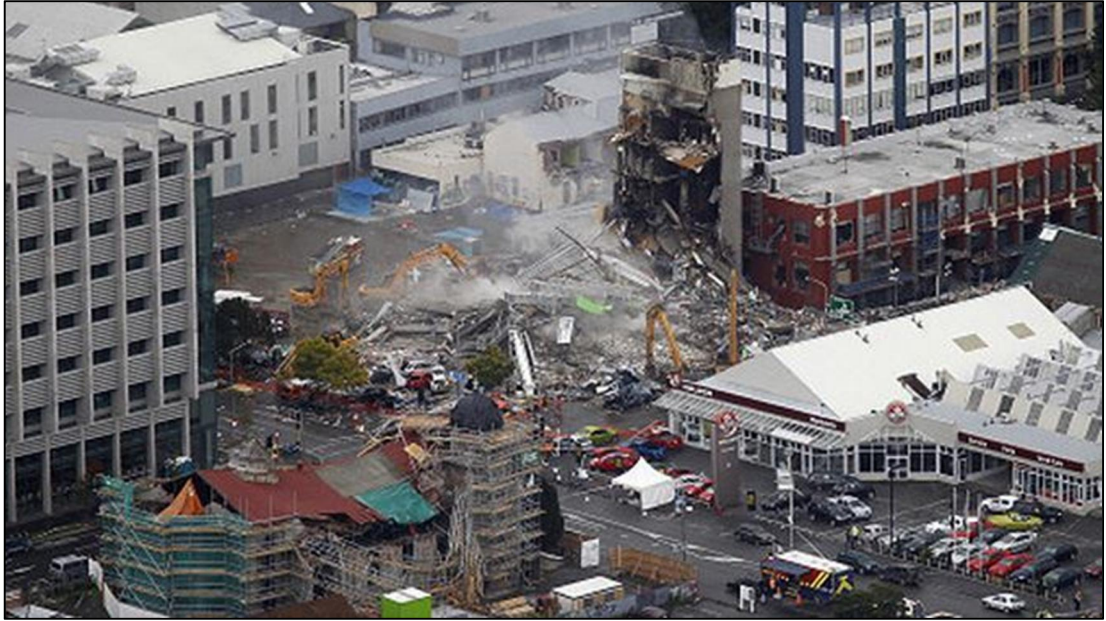
Şekil 2.5: Christchurch Depreminden sonra Canterbury Televizyon Binası
