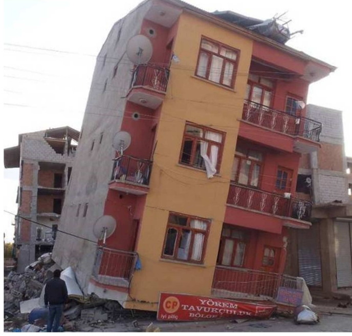
Şekil 2.1: Yumuşak kat nedeniyle zemin katı çökmüş bir bina, Van Depremi, 2011 (M. İNEL, H. B. ÖZMEN, B.T. ÇAYCI, Simav ve Van Depremleri Işığında Ülkemiz Yapılarında Oluşan Deprem Hasarlarının Nedenleri, Teknik Dergi, 2012)
