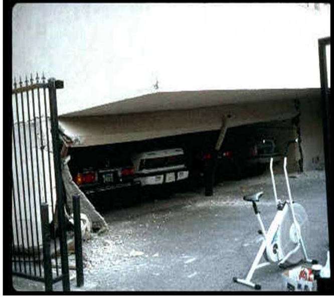
Şekil 2.3: Otopark katında yumuşak kat oluşumu sebebiyle çökmüş bir bina, Northridge Depremi, 1994 (J. Dewey, U.S. Geological Survey)
