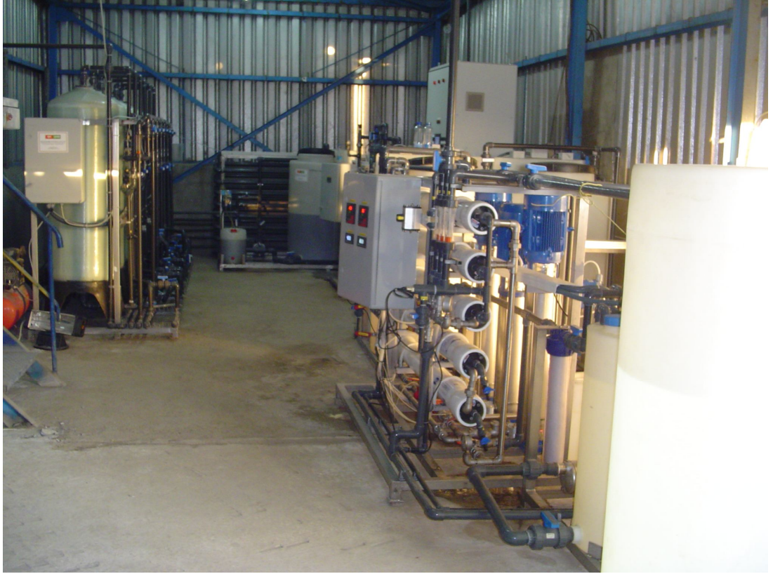
Şekil 3.3: Atıksu geri dönüşümü sistemi pilot tesisi
