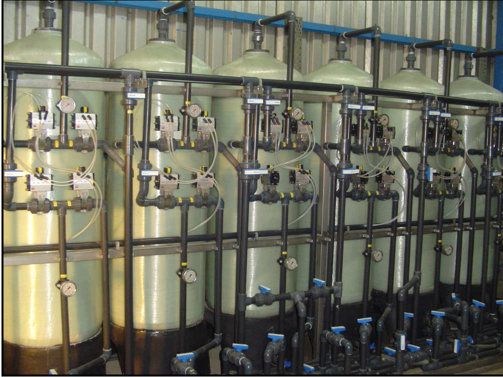
Şekil 3.4: Ön filtrasyon ünitesi
