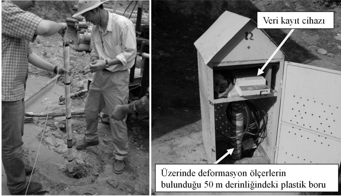
Şekil 5.5 : Kuyu içi deformasyon ölçüm sistemi.
