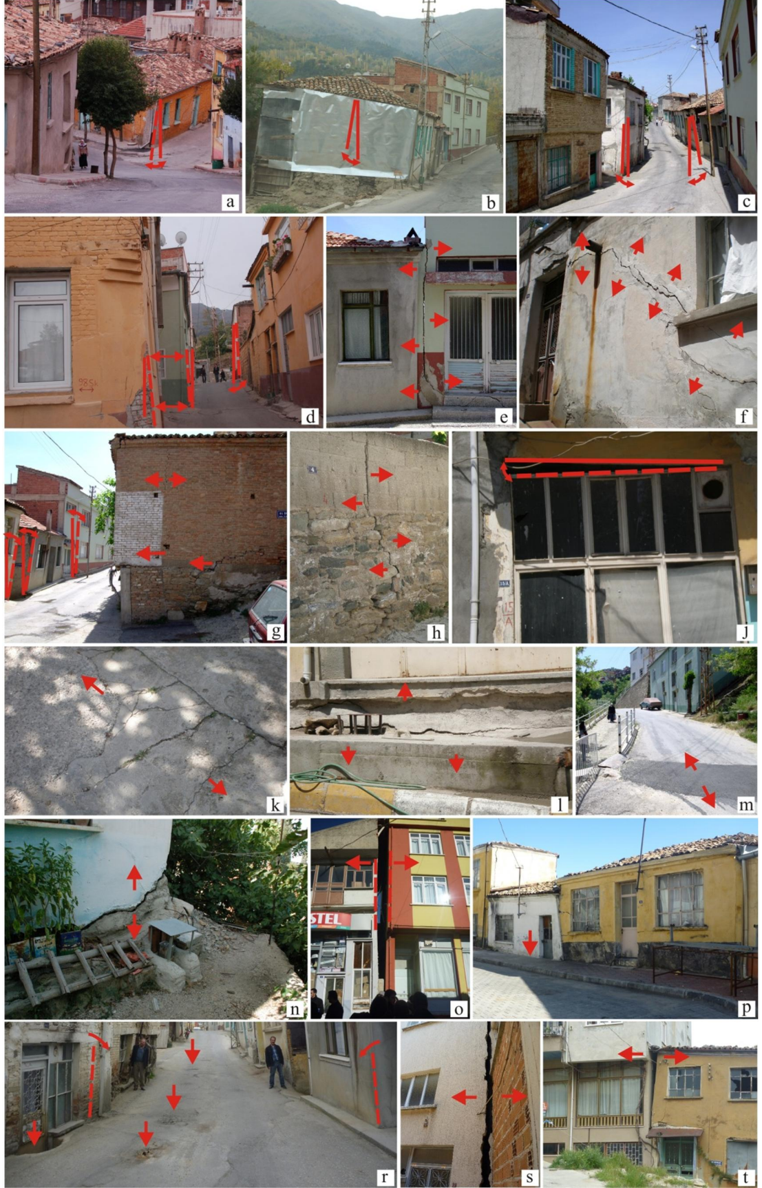
Şekil 1.3 : Gündoğdu Mahallesi'nde, yapı ve yollarda yamaç hareketi nedeniyle gelişen olumsuzluklara örnekler.
