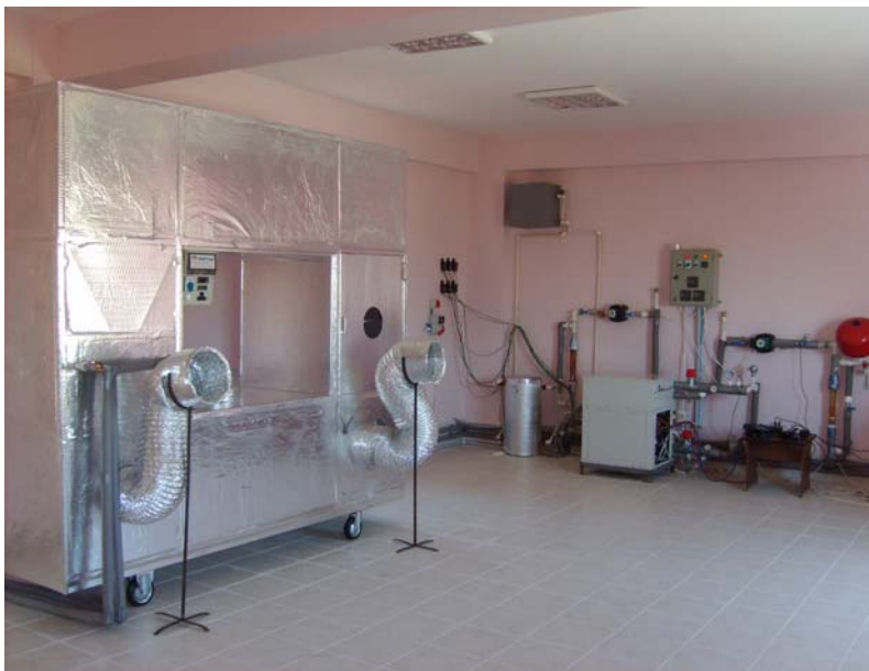
Şekil 4.17 Toprak destekli ısı pompası sistemi ve kurutma sistemi.
