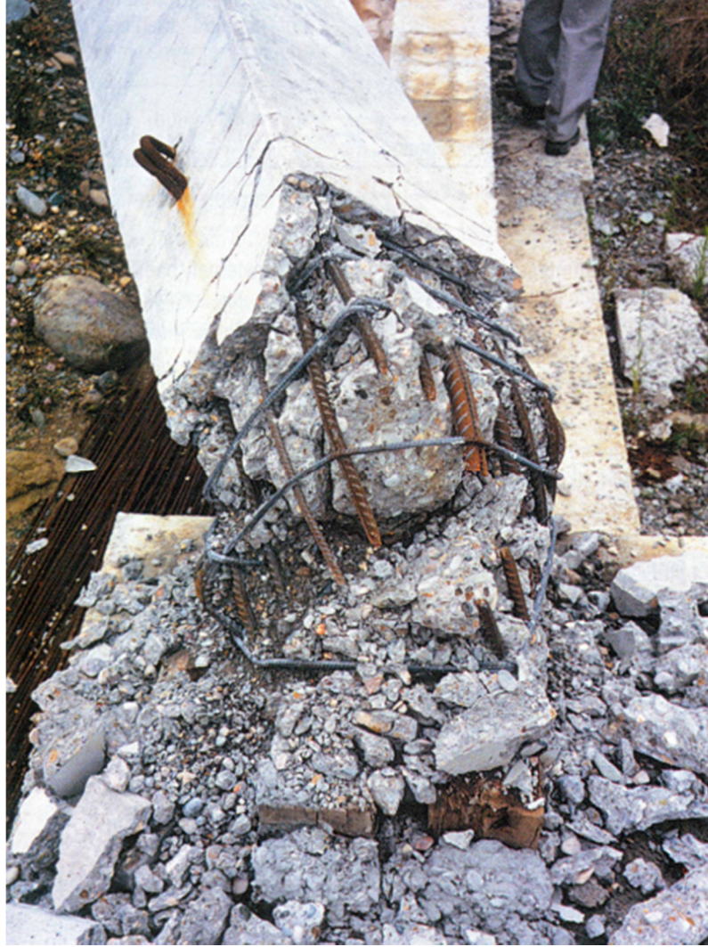
Şekil 3.4: 1999 Marmara depreminde kolonda oluşan plastik mafsal hasarı (Ataköy;1999)
