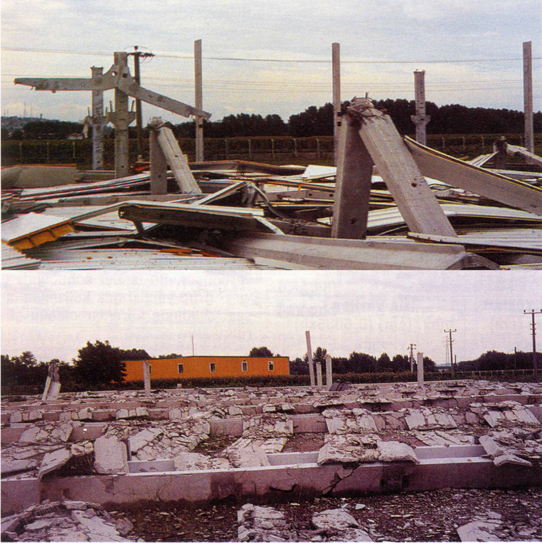
Şekil 3.1: 1999 Marmara depreminde toptan göçme prefabrik yapılar (Ataköy;1999)
