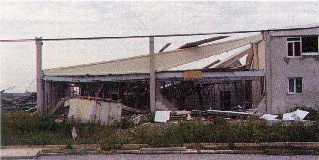
Şekil 3.2: 1999 Marmara depreminde prefabrik makas elemanın devrilmesi ile oluşan hasar (Ataköy;1999)
