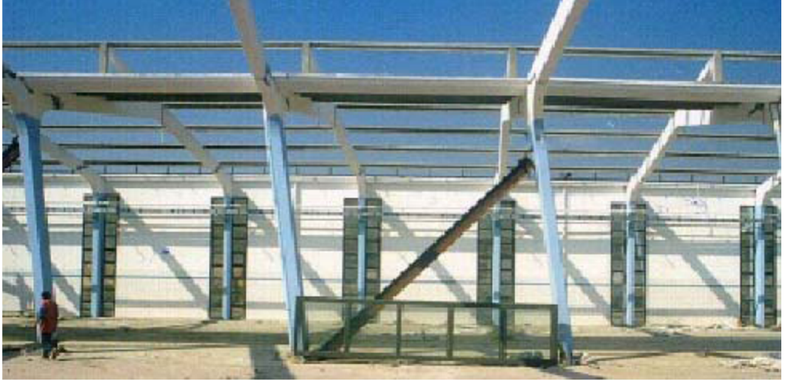
Şekil 3.3: 1999 Marmara depreminde toptan göçme prefabrik yapılar (Ersoy, 2000)
