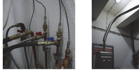
Şekil 9. Sıcaklık problemlerinin yakından görünümü ve kombi baca bağlantısı (Close view of the temperature probes and chimney connection)
