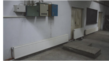
Şekil 10. Isıtma devresi petek grubu (Radiator group of heating cycle)
