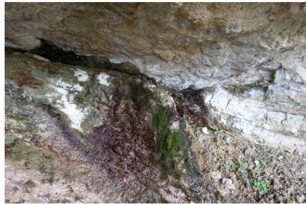
Şekil 8: Çatlaklar arasından sızan zemin suyu.
