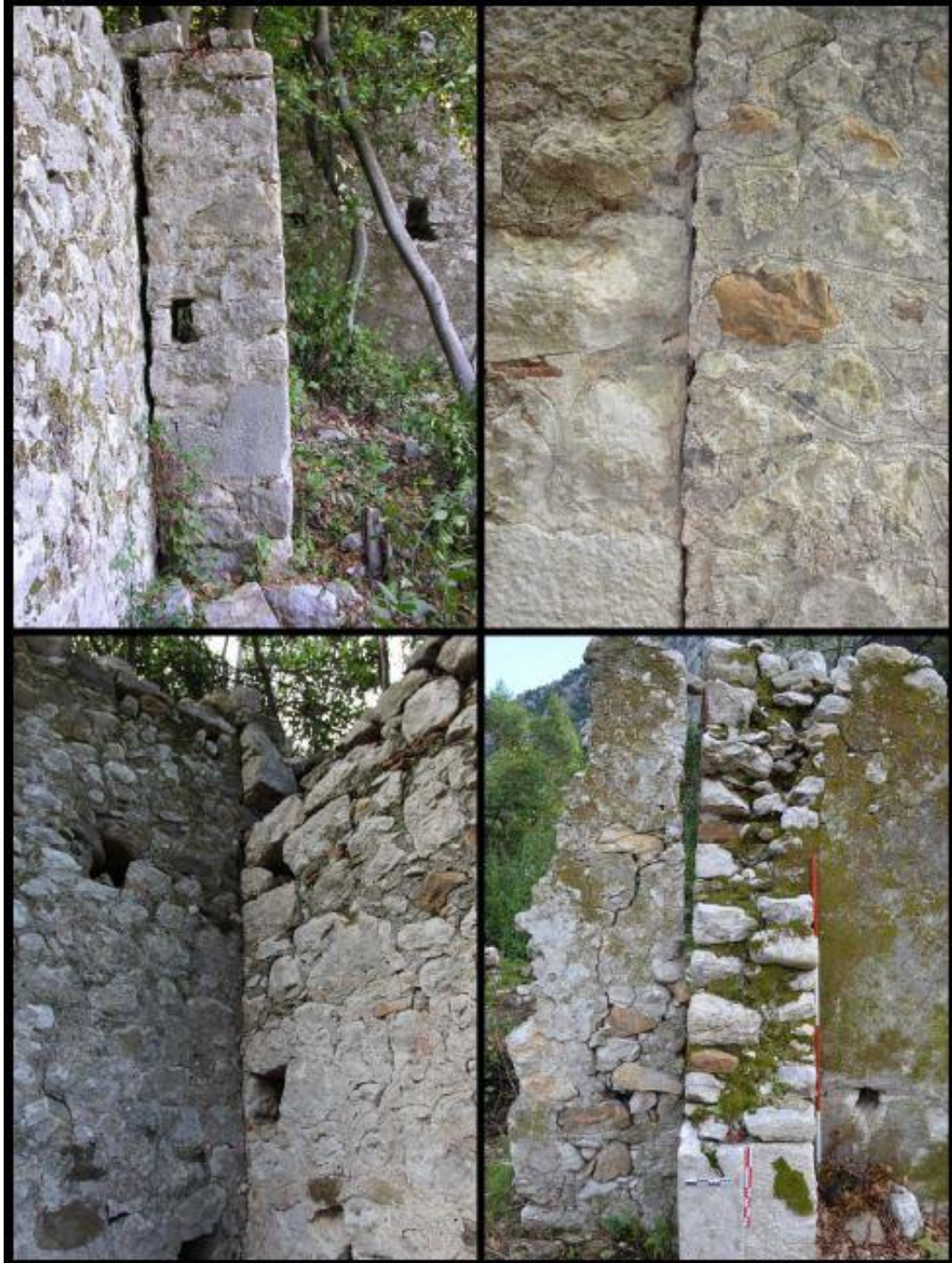
Şekil 30. Kilisede görülen dilatasyon derzi örnekleri (Uzun, 2015: Lev. 35a)
