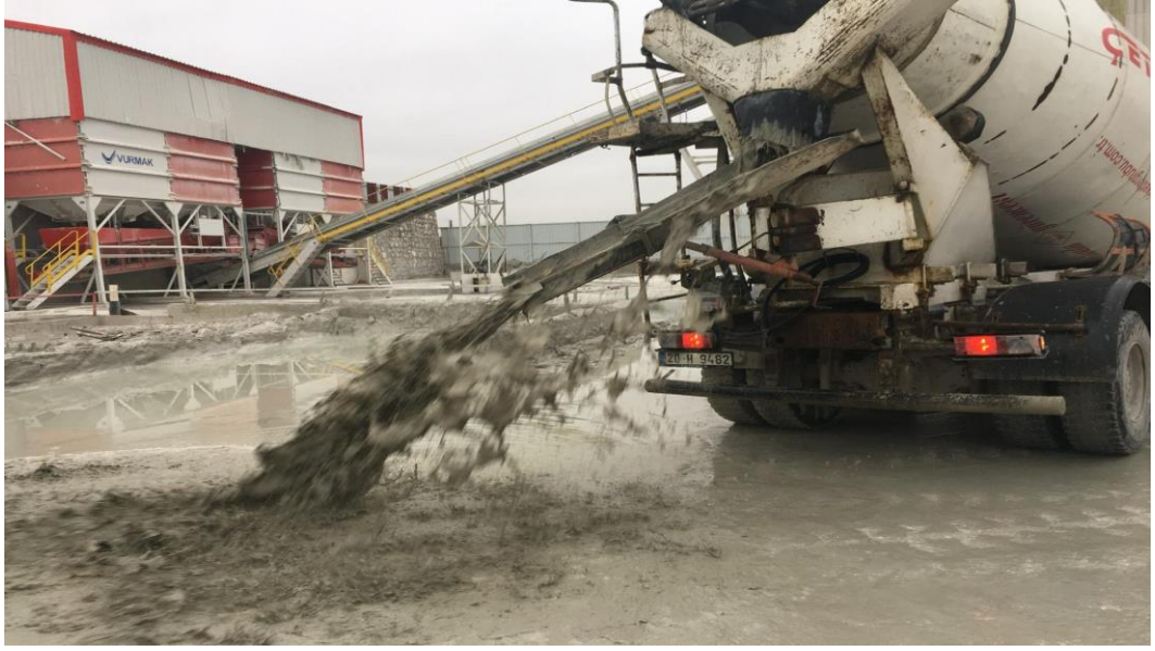
Şekil 3.3: Transmikser karıştırma haznesinin yıkanması ile oluşan atıksu.
