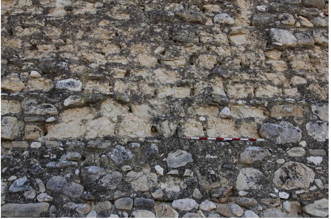
Fig.44e: Ge Bizans Batı Surunun Batı Cephesi'nde Yer Alan Dökülmeler ve İskele Delikleri.
