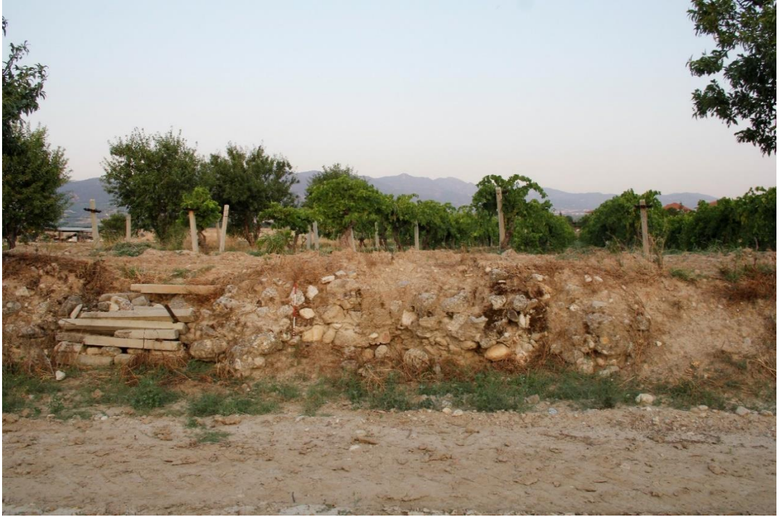
Fig.43: Tarlalar Arasında Sınır Olarak Kullanılan Güneybatı Köşedeki Geç Bizans Surun Doğu Cephesi.
