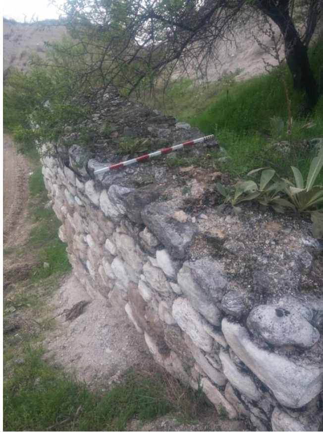
Fig.71d: Hacı Osman Zeytinliđi Mevkisi Yıkılmıř evre Sur Detayı.
