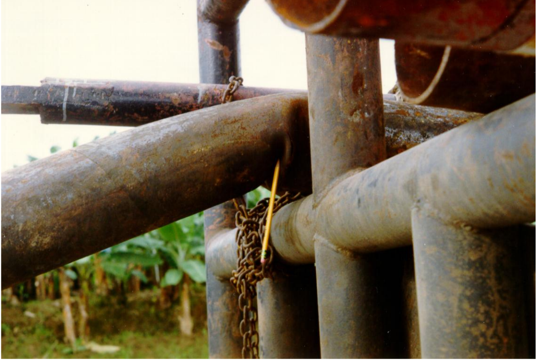
Şekil 3.7: Boruda bölgesel burkulma (O'Rourke ve Ballantyne 1992)
