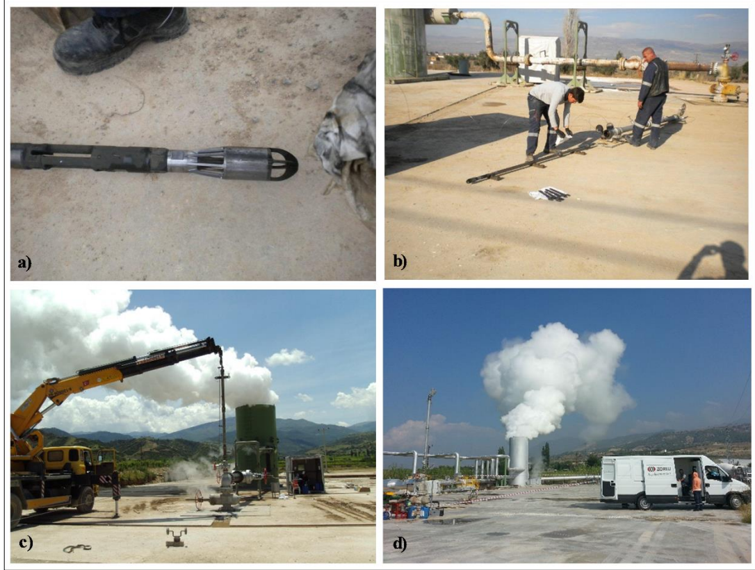
Şekil 4.9: Kuyu içi dinamik basınç ve sıcaklık ölçümü. a) Kuster marka PTS aleti. b) kuyuya gönderilmeden önce PTS aletinin lubrikatör içine yerleştirilmesi. c) Vinç yardımıyla lubrikatörün kuyu başına monte edilmesi. d) Mobil araca monte edilmiş makara sistemiyle PTS'in lubrikatör aracılığıyla kuyu içinde gönderilmesi ve dinamik basınç-sıcaklık ölçümlerinin yapılması.
