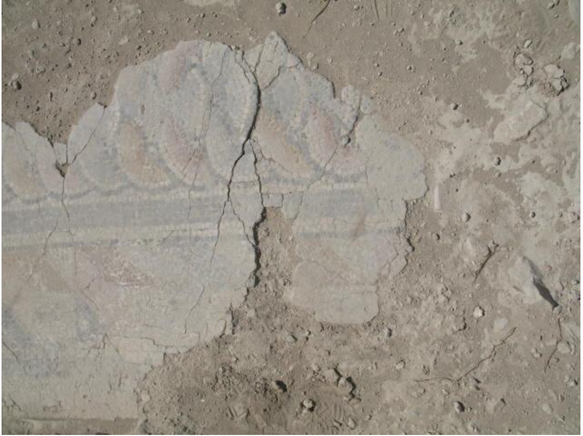
Resim 11: Çatlak Bozulma Örneği
