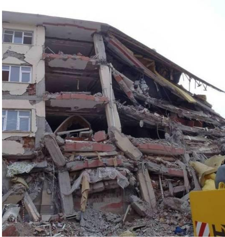
Şekil 1.2: 2011 Van depreminde ağır hasar almış bir yapı (İnel ve diğ. 2011)
