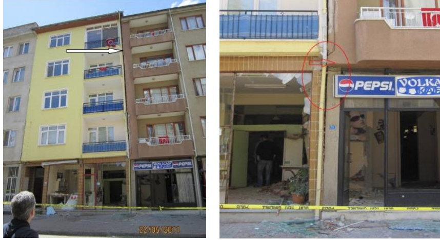
Şekil 2.2: Simav depreminde çekiçleme etkisiyle kalıcı hasar görmüş bina (Ozmen ve diğ., 2011)
