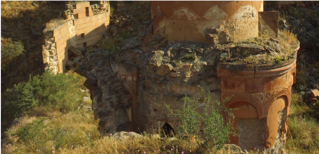
Resim 418: Bakireler Manastırı Kilisesi, tahrip olan güneybatı konch cephesi
