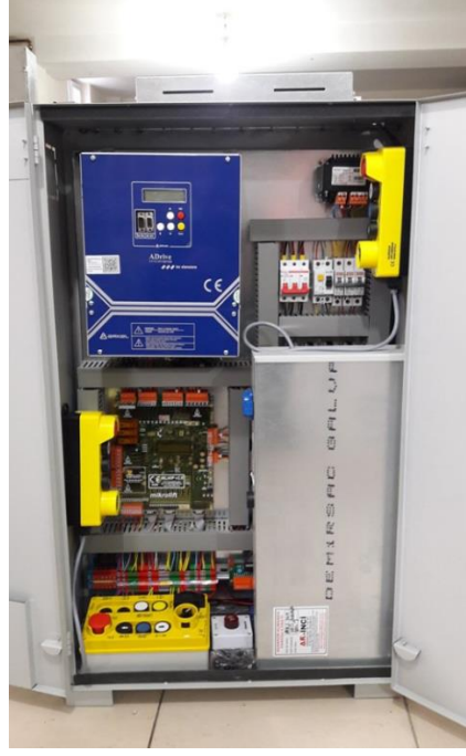
Şekil 2.12: Kumanda panosu (Kontrol paneli)
