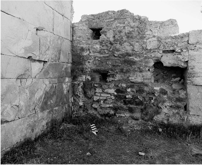
Res. 17 Merkezi Hamam'da ikinci Frigidarium kısmında Yörük yerleşimini gösteren duvardaki is izleri ve ateşe maruz kalarak yanan traverten taşlar ve tuğlalar
