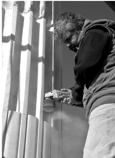
Res. 25 Kuzey (Kutsal) Agora Doğu portiğinde ayağa kaldırılan sütunda yapılan eksik tamburun yeni mermerden yapılması ve işlenmesi safhası
