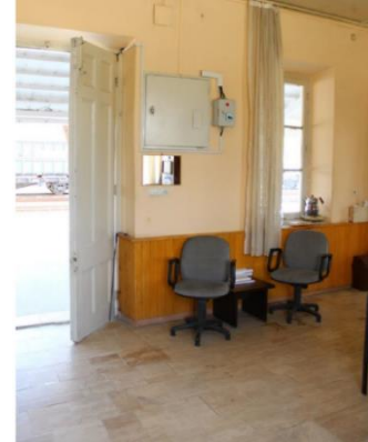
Foto 216: Kaklık İstasyon Binası, 2 nolu mekânın güneydoğu duvarında yer alan giriş açıklığı ve pencere.
