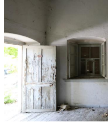
Foto 138: Böceli İstasyon Binası, İşçi Barakası ve Lojman Binası, 1 no.lu mekânın güneybatı duvarındaki giriş.
