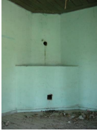
Foto 187: Kocabaş İstasyon Binası, 4 nolu mekânın kuzeydoğu duvarı.
