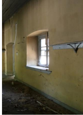
Foto 139: Böceli İstasyon Binası, İşçi Barakası ve Lojman Binası, 2 no.lu mekânın kuzeydoğu duvarı.
