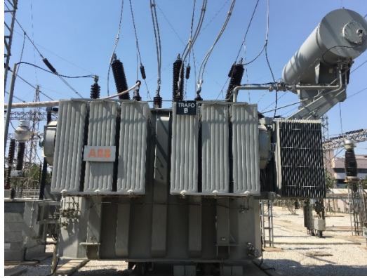
Şekil 2.2: 50 MVA gücündeki bir transformatörün genel görünüşü
