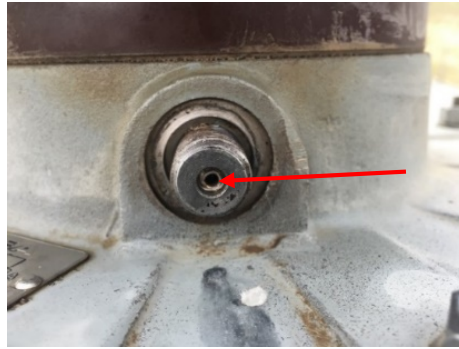
Şekil 7.10: Tap kapağı ve sızan yağ
