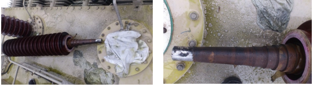
(a) b) Şekil 7.23: (a) Arızalı buşing ve (b) dom içerisinde kalan kısım
