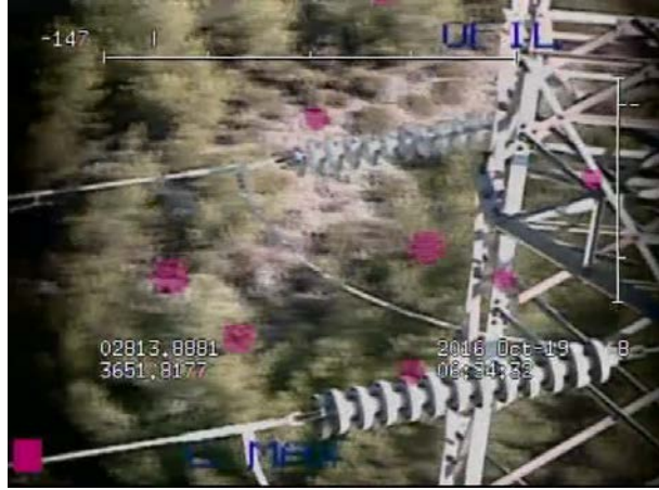
Şekil 4.11: Korona kamerası ile tespit edilen 154 kV izolatör bağlantılarındaki deşarjlar
