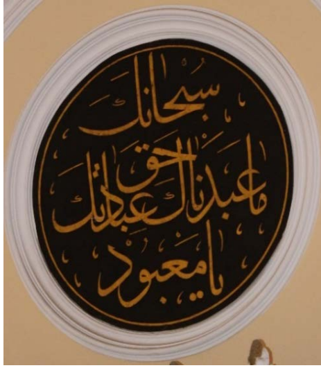
Fot. 173: Batı Cephe Güney Köşedeki Kartuş.
